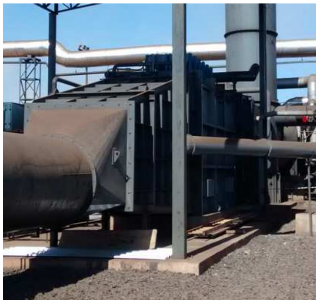
Figura 2.29. Trocador de calor da EFGT instalado na UPE Buriti no projeto Arcelor/Cemig.
