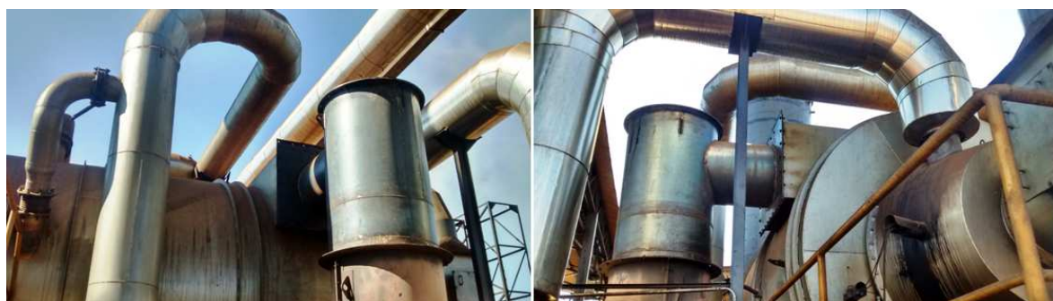
Figura 3.9. Queimador de gases do projeto EFGT - Arcelor/Cemig, vistas parciais.
