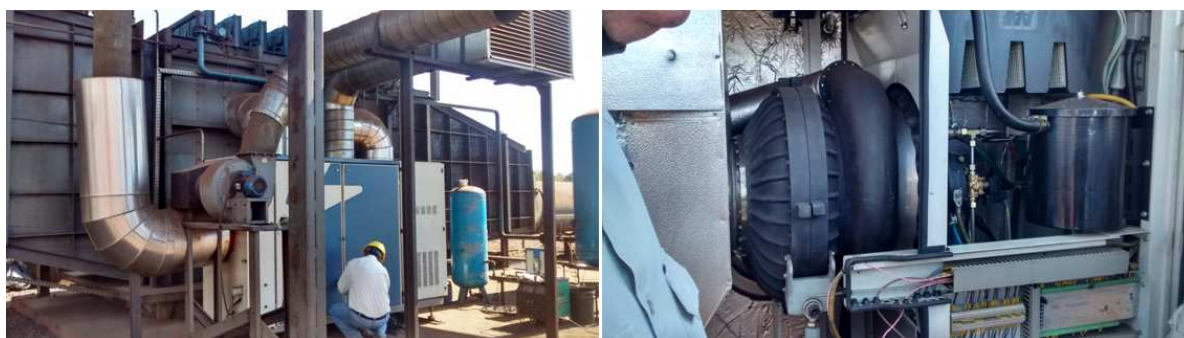
Figura 2.28. EFGT instalada na UPE Buriti no projeto Arcelor/Cemig.
