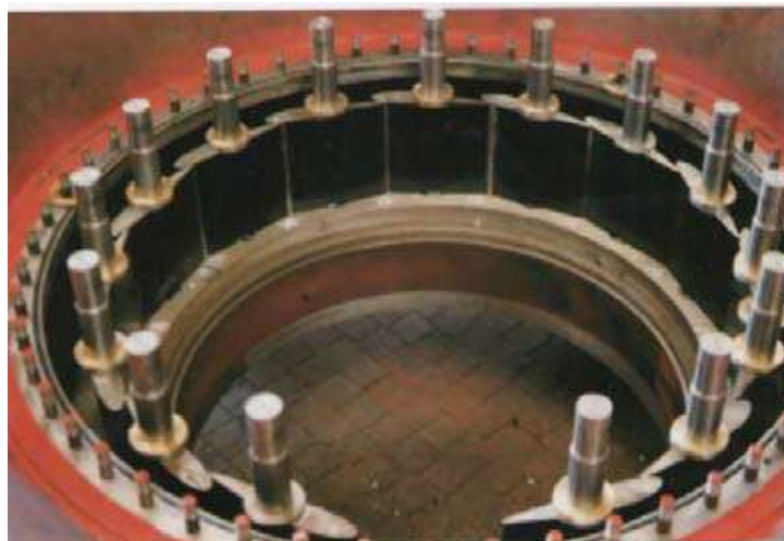
Fig. 3.10 Distribuidor de uma turbina Francis da UHE Eloy Chaves.
