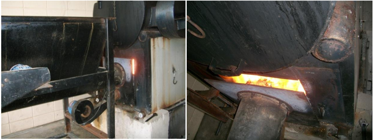
Figuras 4.93 e 4.94 - Detalhes do sistema de alimentação e queima de biomassa na caldeira
