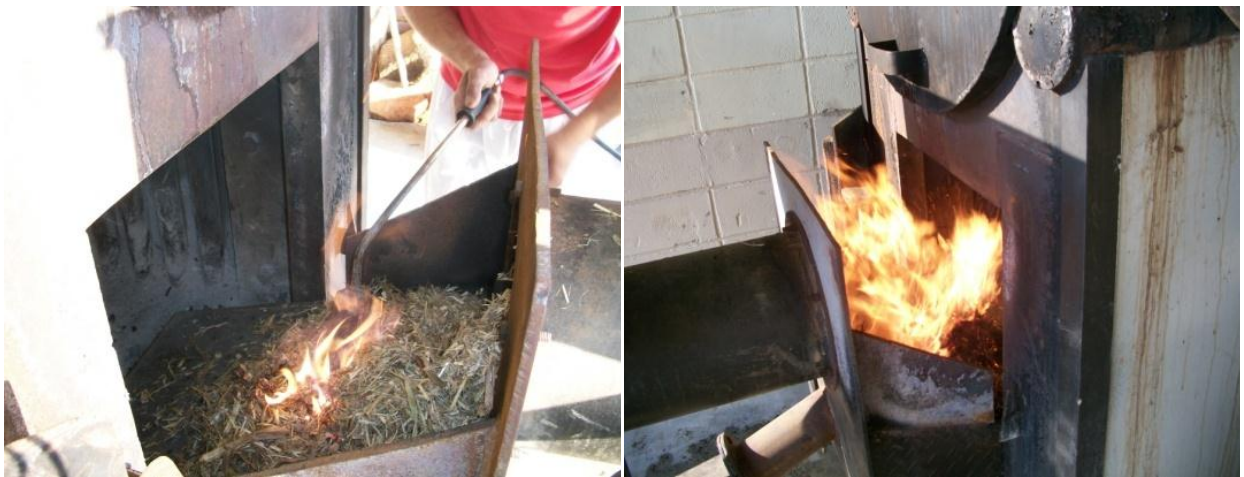
Figuras 4.88 e 4.89 - Detalhes do sistema de queima de biomassa na caldeira
