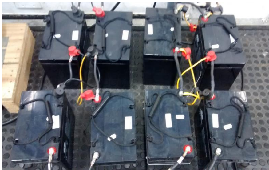
Figura 4.24 – Banco de baterias.
