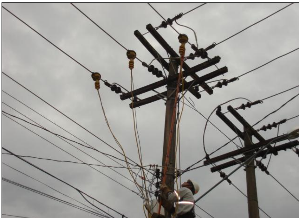
Figura 24: Instalação do medidor Marh-MT na saída da subestação, no alimentador ITC-04.
