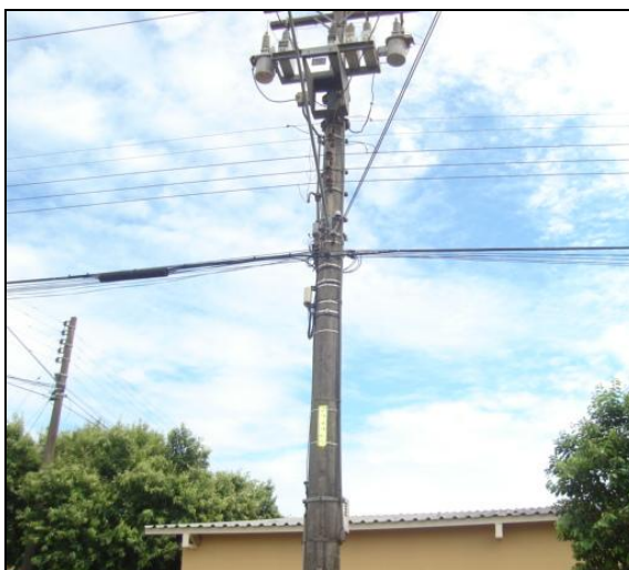
Figura 9: Banco de Capacitores n° 294965 (BC-2).
