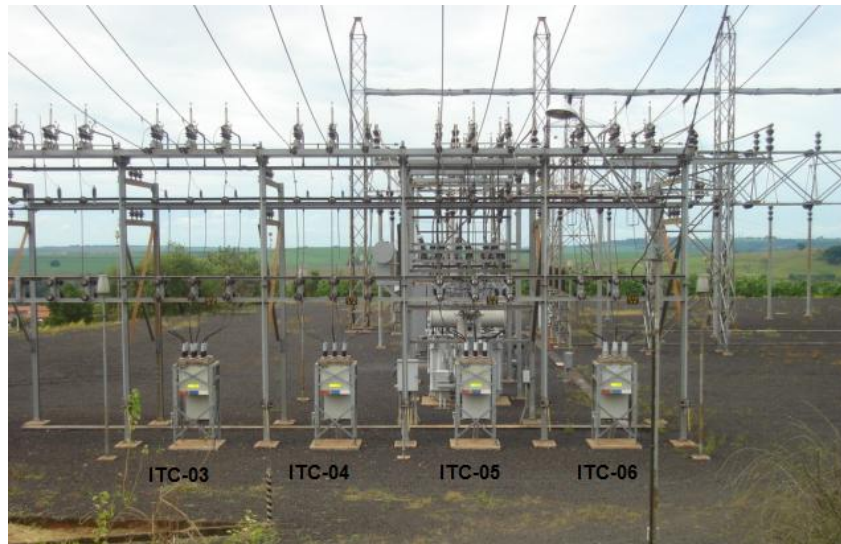
Figura 6: Foto da subestação de Itacolomi.
