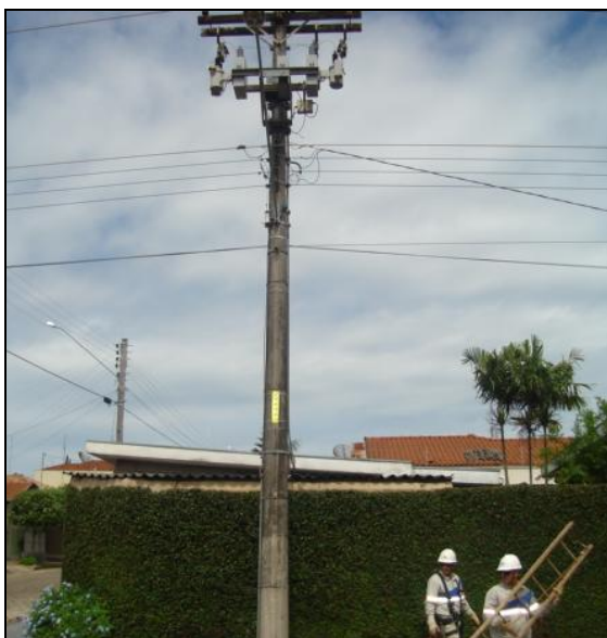
Figura 8: Banco de Capacitores n° 294944 (BC-1)
