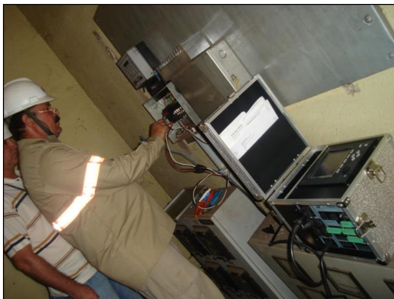
Figura 28: Instalação do medidor Power ION na fundição F B .
