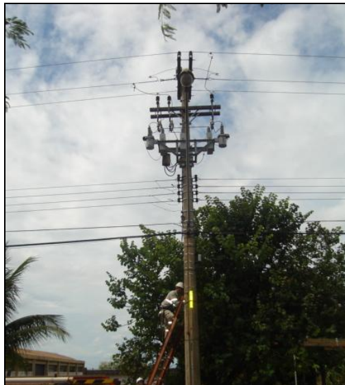
Figura 10: Banco de Capacitores n° 397528 (BC-3).
