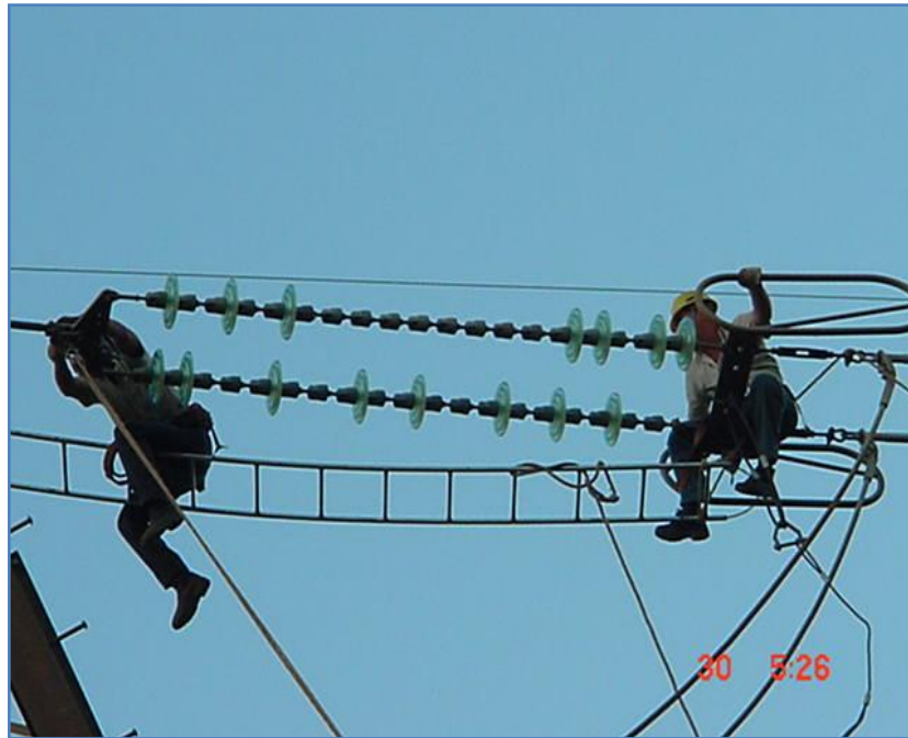
Figura 2.6 - Danos às cadeias de isoladores causados por vandalismo
