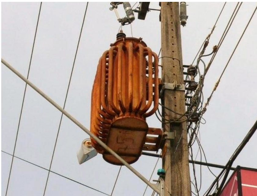
Figura 8.1 – Transformador em mau estado
