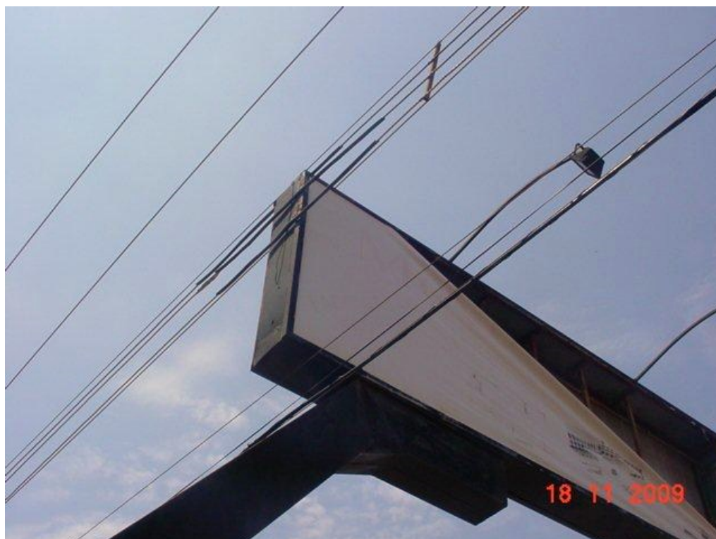
Figura 8.5 - Rede de Baixa Tensão em contato com painel metálico
