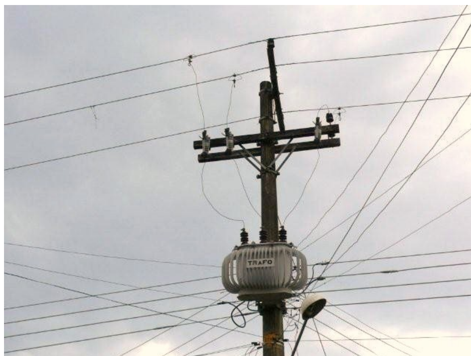
Figura 8.8 – Transformador sem para-raios de proteção
