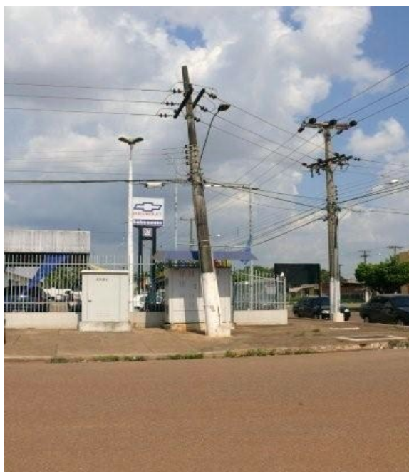
Figura 8.7 - Poste fora de prumo
