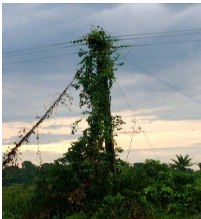
Figura 8.6 - Vegetação encobrindo estrutura
