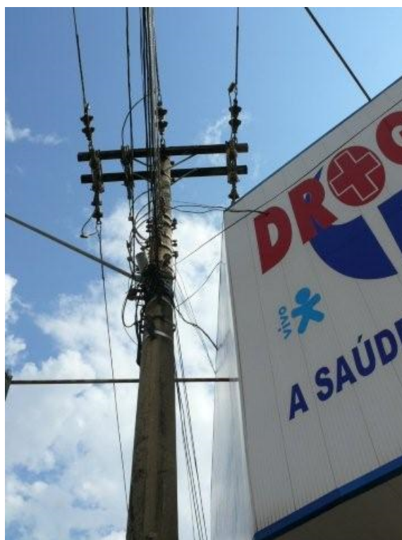
Figura 8.2 - Rede de Distribuição próxima de painel metálico
