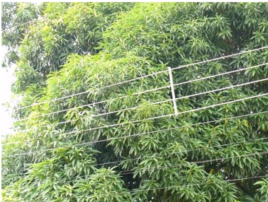
Figura 8.9 – Utilização de espaçador na Baixa Tensão/Exemplo 1
