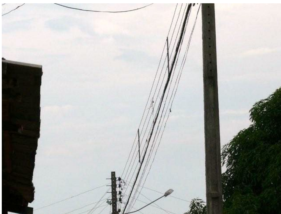
Figura 8.10 – Utilização de espaçador na Baixa Tensão/Exemplo 2
