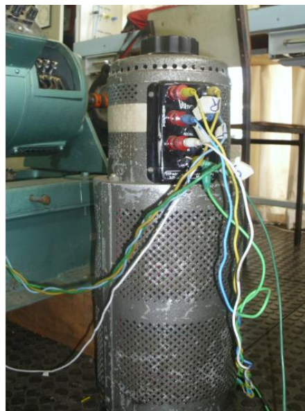
Figura 4.14 – Autotransformador aplicado na conexão do VFT
