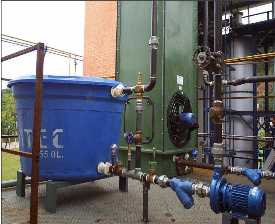
Figura 4.3 – Resistências elétricas e torre de resfriamento.
