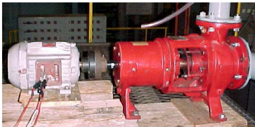
Figura 5.4 – Conjunto BFT acoplado ao gerador indução
