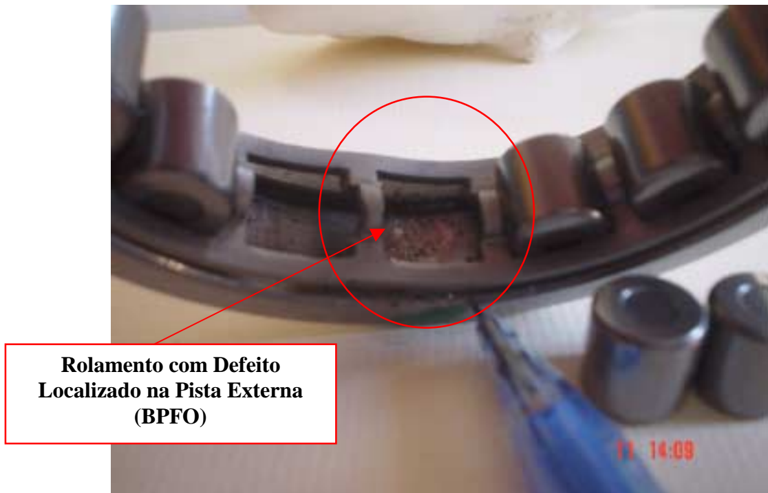
Figura 5.21 – Rolamento com defeito na pista externa – classe K3
