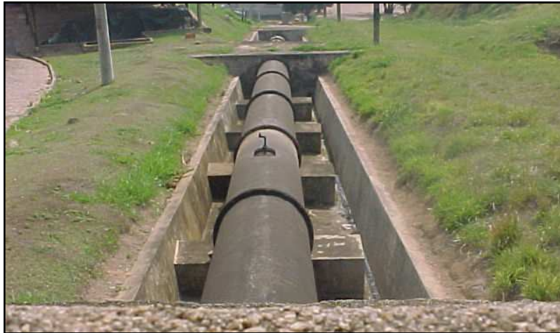
Figura 18: Tubulação de baixa pressão
