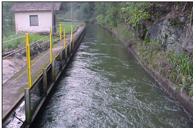
Figura 16: Canal de Adução.
