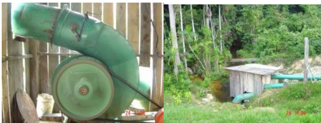
FIG. 12-TURBINA HIDRÁULICA E CASA DE FORÇA DA USINA DE AÇAIZAL
