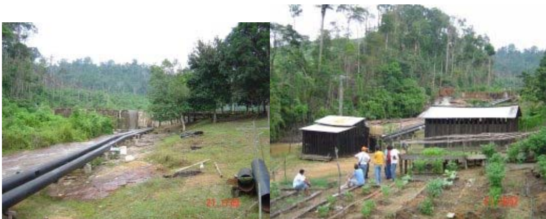
FIG. 7 - TOMADA D'ÁGUA E VISTA GERAL DA CASA DE FORÇA
