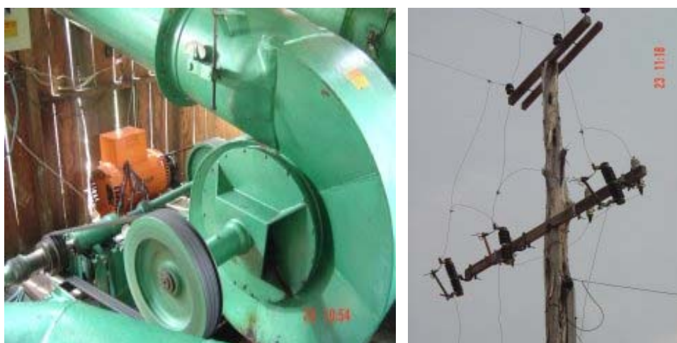
FIG. 10 - TURBINAS HIDRÁULICAS E REDE DE TRANSMISSÃO 13,8 kV
