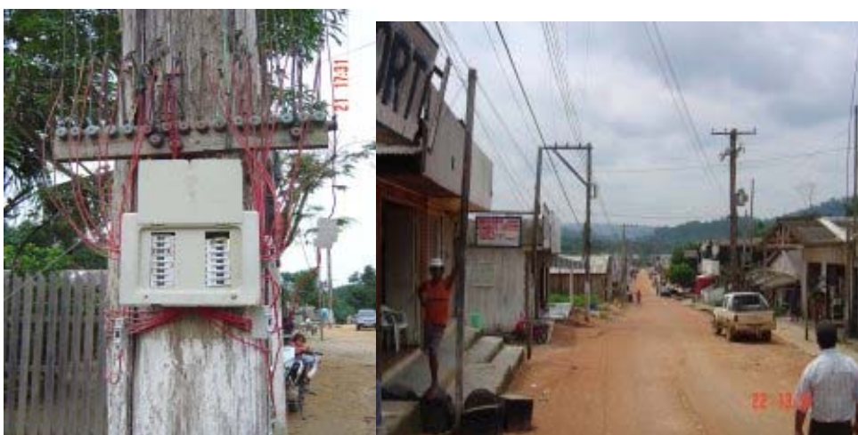
FIG. 8 - DISTRIBUIÇÃO BAIXA TENSÃO E VISTA DO COMÉRCIO LOCAL
