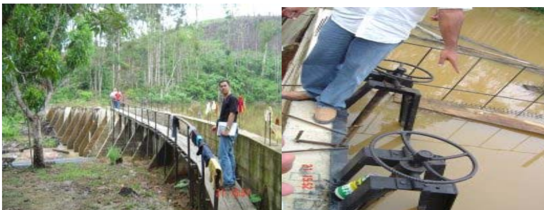
FIG. 6 - BARRAGEM E COMPORTAS DA USINA CREPURIZÃO.
