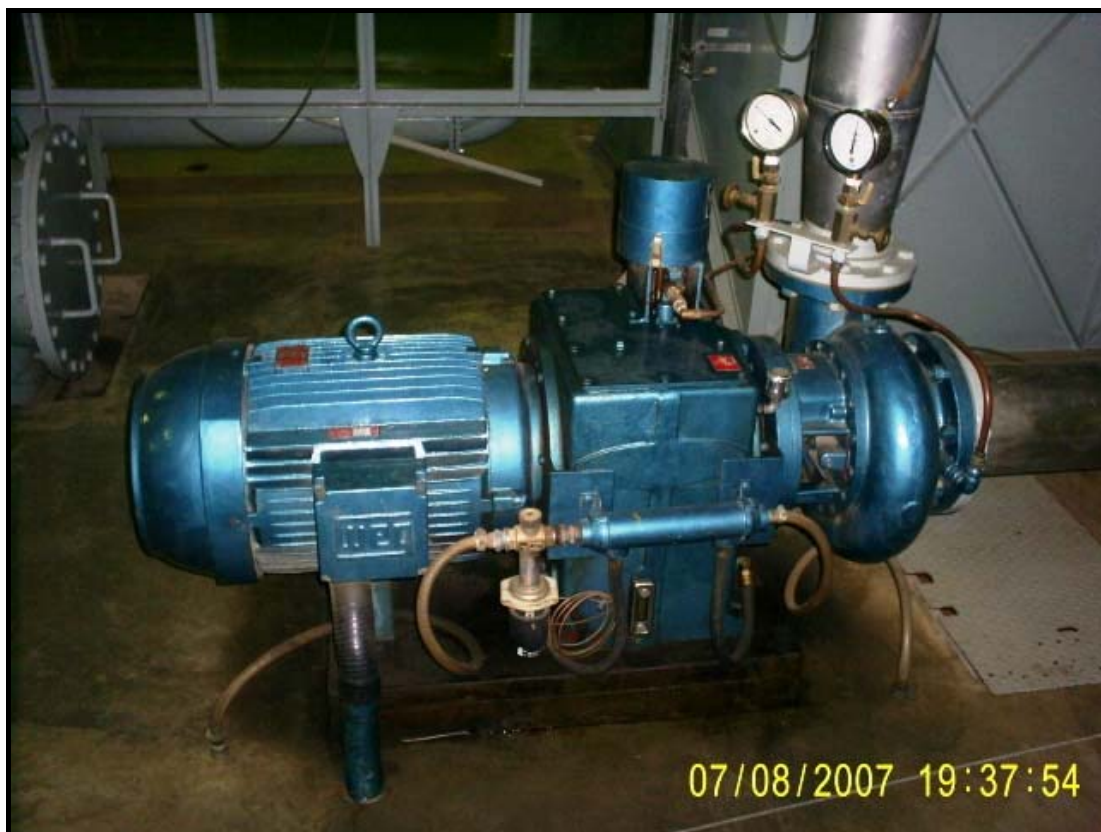
Figura 3-3 - Bomba de alimentação do sistema
