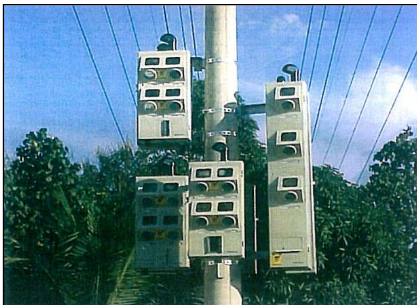
Figura 2.13: Tecnologia antifurto - Caixa Padrão Rede da Empresa Distribuidora CELPA. Fonte: (ROCHA, 2011).
