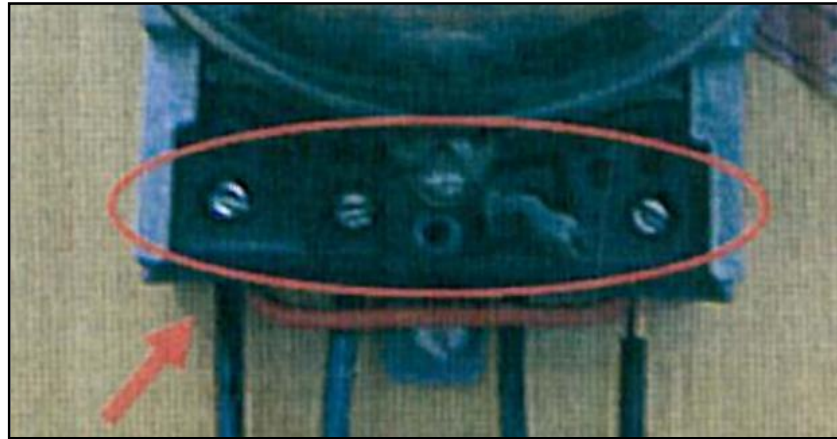
Figura 2.8: Fraude - Jumper nos fios de ligação do medidor. Fonte: (ROCHA, 2011).
