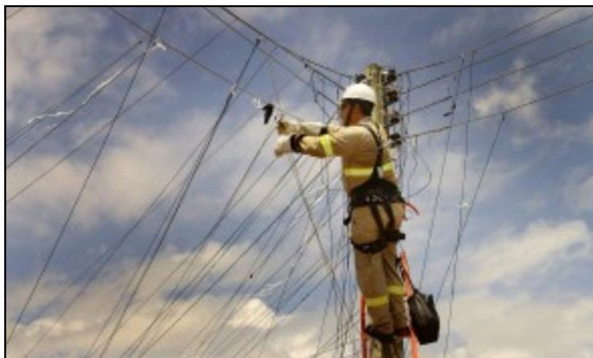
Figura 2.7: Furtos - Gatos de energia elétrica na rede de baixa tensão. Fonte: (ELETROBRÁS AMAZONAS).
