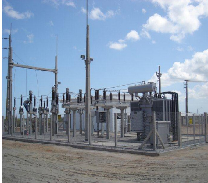
Figura 3.1 - Subestação de energia elétrica
