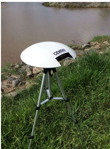
Figura 31 – Aparelho de monitoramento de barragens. Fonte: Próprio autor
