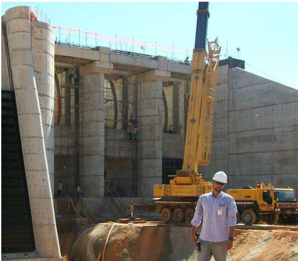
Figura 5 – Construção do vertedouro da PCH Parecis no rio Juruena –MT. Fonte: Próprio autor
