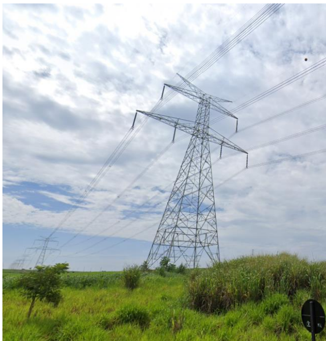
Figura 4.1 - Torre de Transmissão da LT Ilha Solteira - Bauru circuito 1 e 2.
