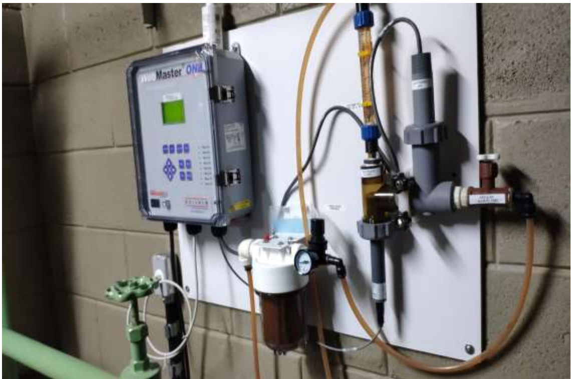
Figura 24: Painel de controle geral de dosagem e injeção do hipoclorito de cálcio Fonte: acervo do autor (2019)
