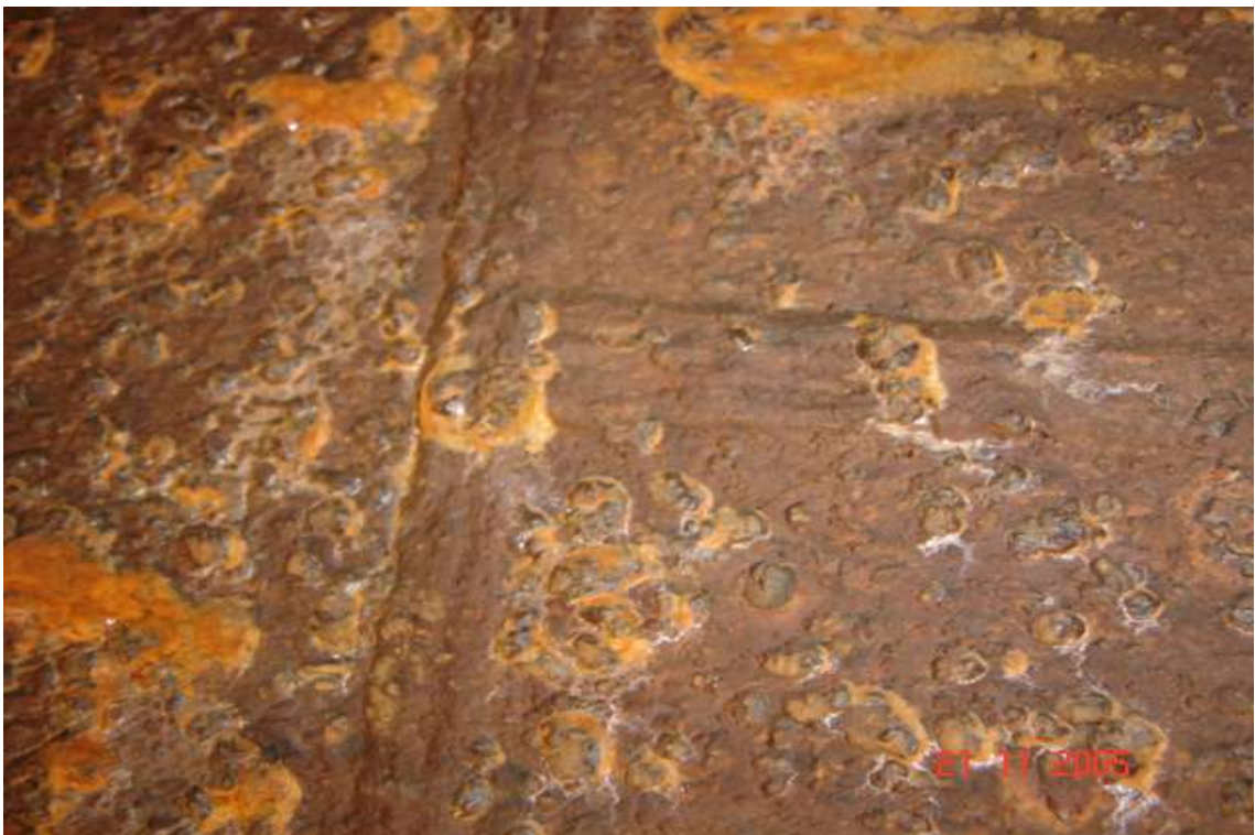
Figura 64: Situação do conduto forçado sem pintura material SAR-50 de 19 mm de espessura.
