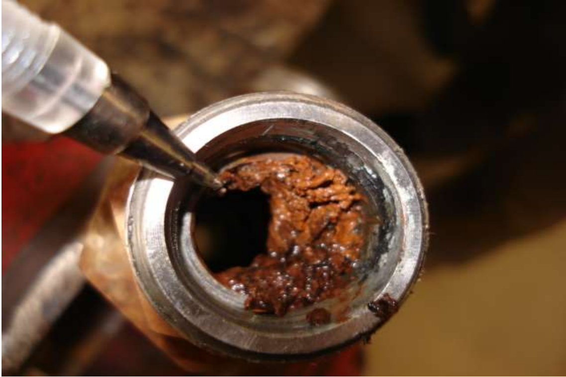
Figura 8: Tubulação da vedação de eixo de turbina atacada por ferrobactéria + bactéria redutora de sulfato. Fonte: acervo do autor (2005)
