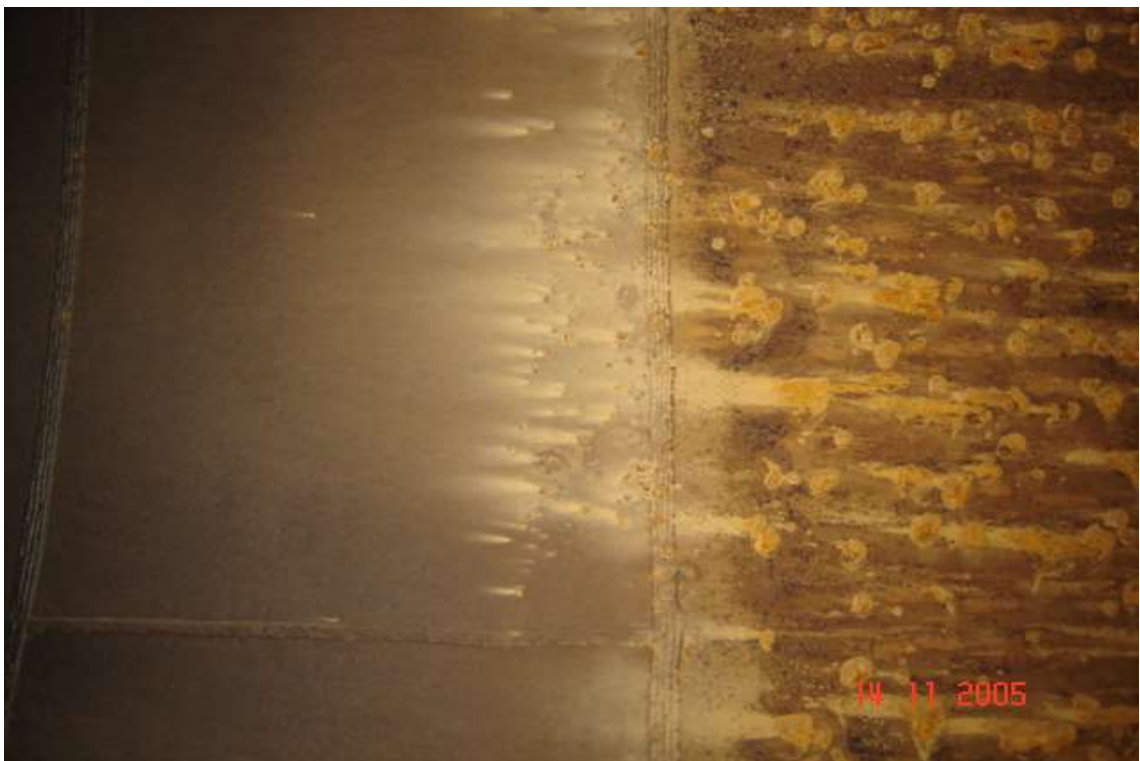
Figura 22: Comparação da diferença entre caixa espiral pintada e conduto forçado sem pintura. Fonte: acervo do autor (2005)
