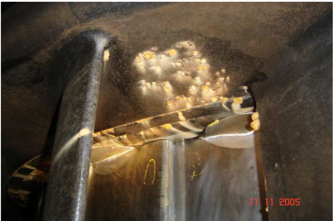
Figura 66: Corrosão no teto do pré-distribuidor
