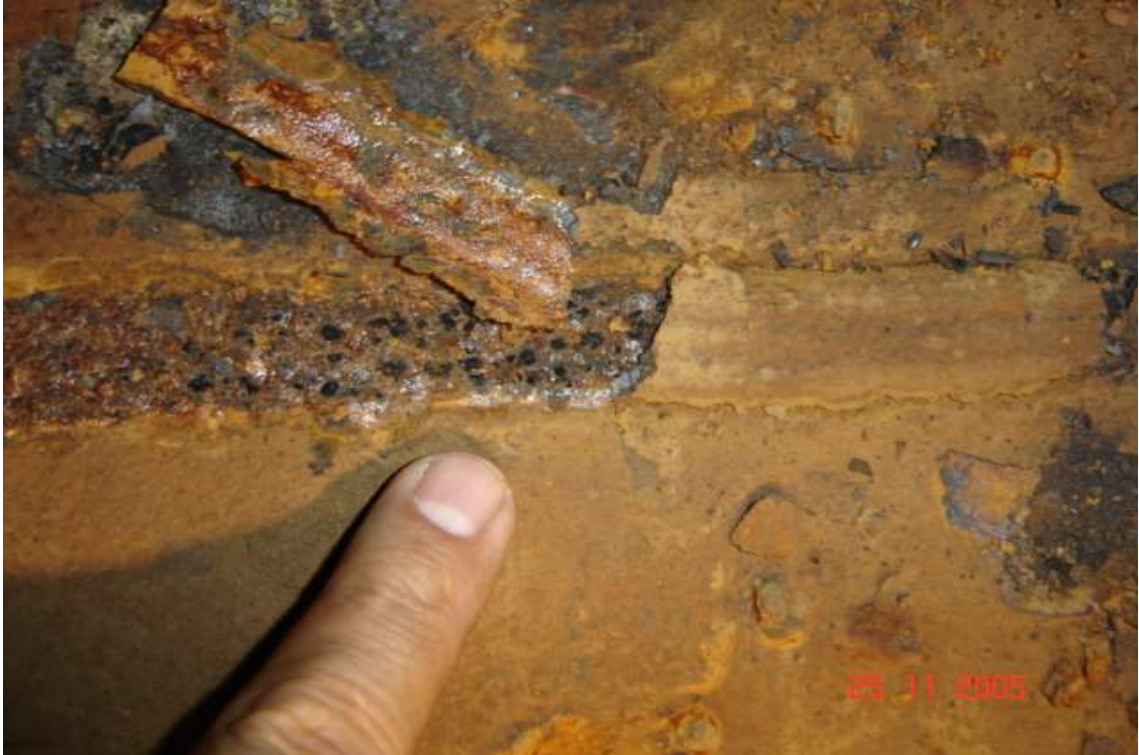
Figura 65: Corrosão removeu até cordão de acabamento da solda após 6.836 horas de operação.
