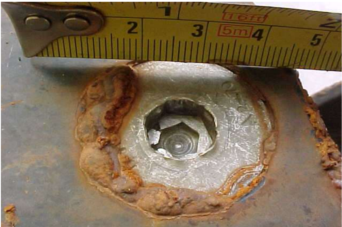
Figura 73: Corrosão no alojamento de parafusos de rodas.
