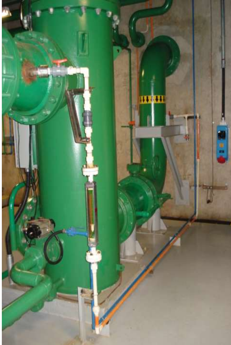
Figura 78: Ponto de injeção após filtro autolimpante do sistema de água de resfriamento.
