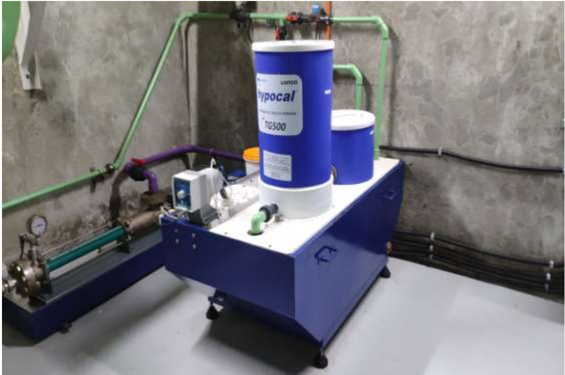
Figura 23: Reservatório de biocida e bomba do sistema de inibidor químico. Fonte: acervo do autor (2019)
