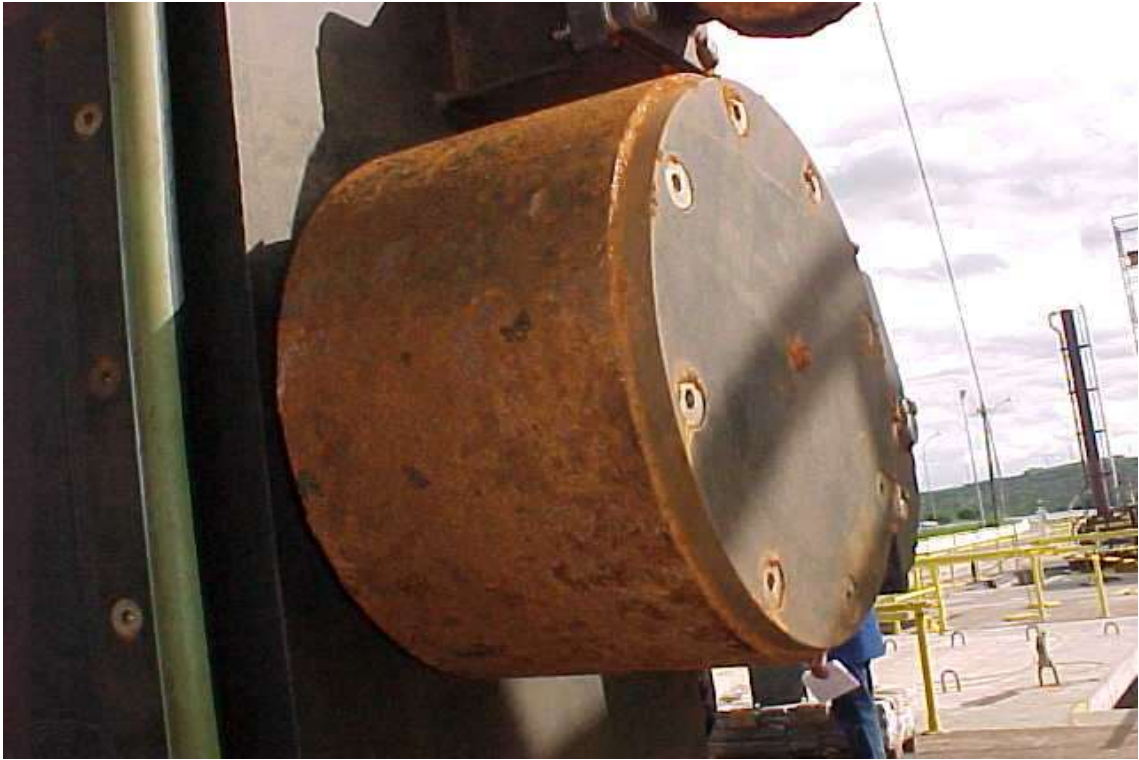
Figura 74: Corrosão na face de rolamento da roda da comporta.
