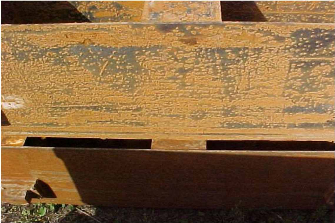
Figura 63: Tubérculos em comporta ensecadeira provisória sem pintura
