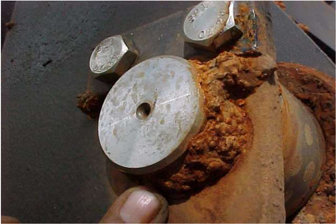
Figura 72: Corrosão no alojamento do eixo de rolete da comporta.
