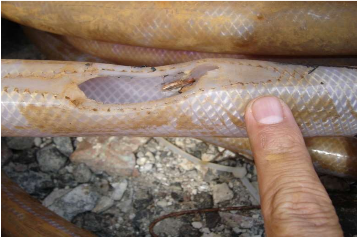
Figura 61: Atrito desgastou proteção e ocasionou curto circuito do sistema.
