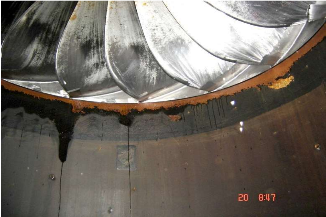
Figura 69: Corrosão na parte superior do aro de saída da turbina
