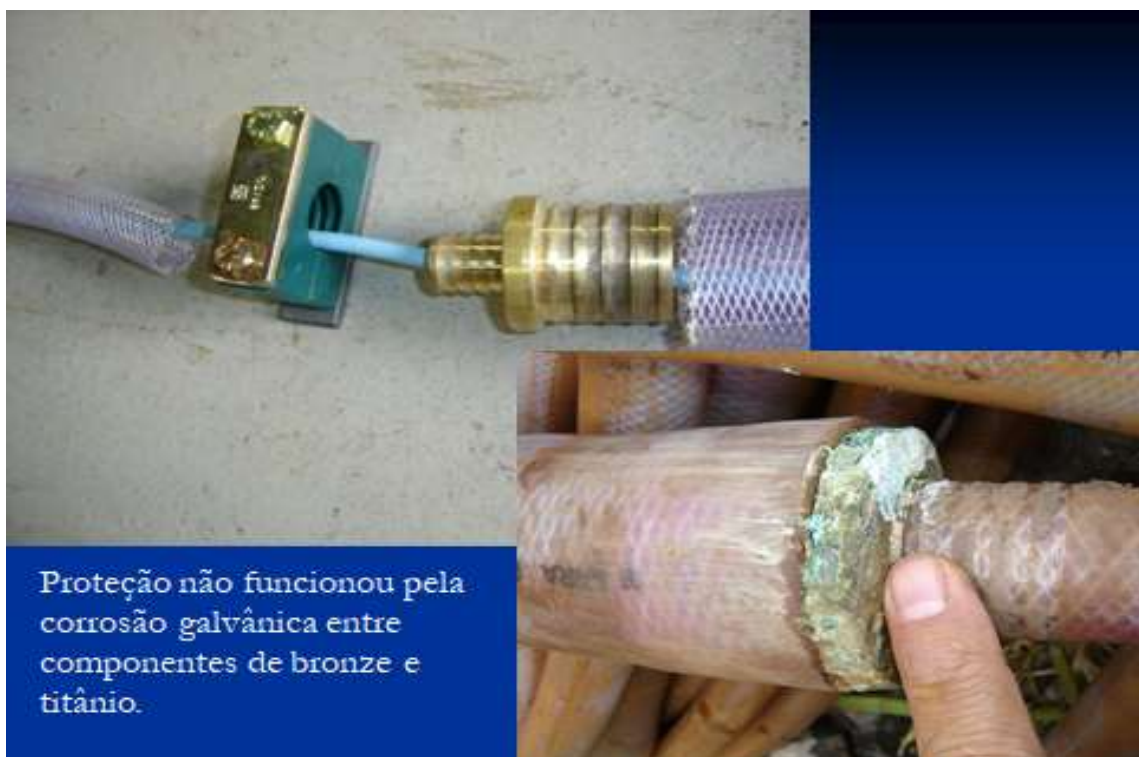
Figura 60: Uma das falhas do sistema instalado.
