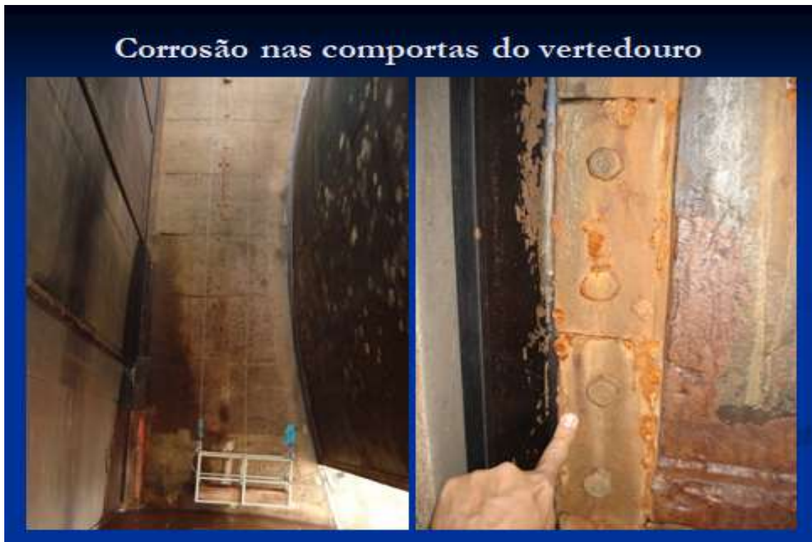
Figura 57: Situação de biocorrosão na face da comporta segmento.
