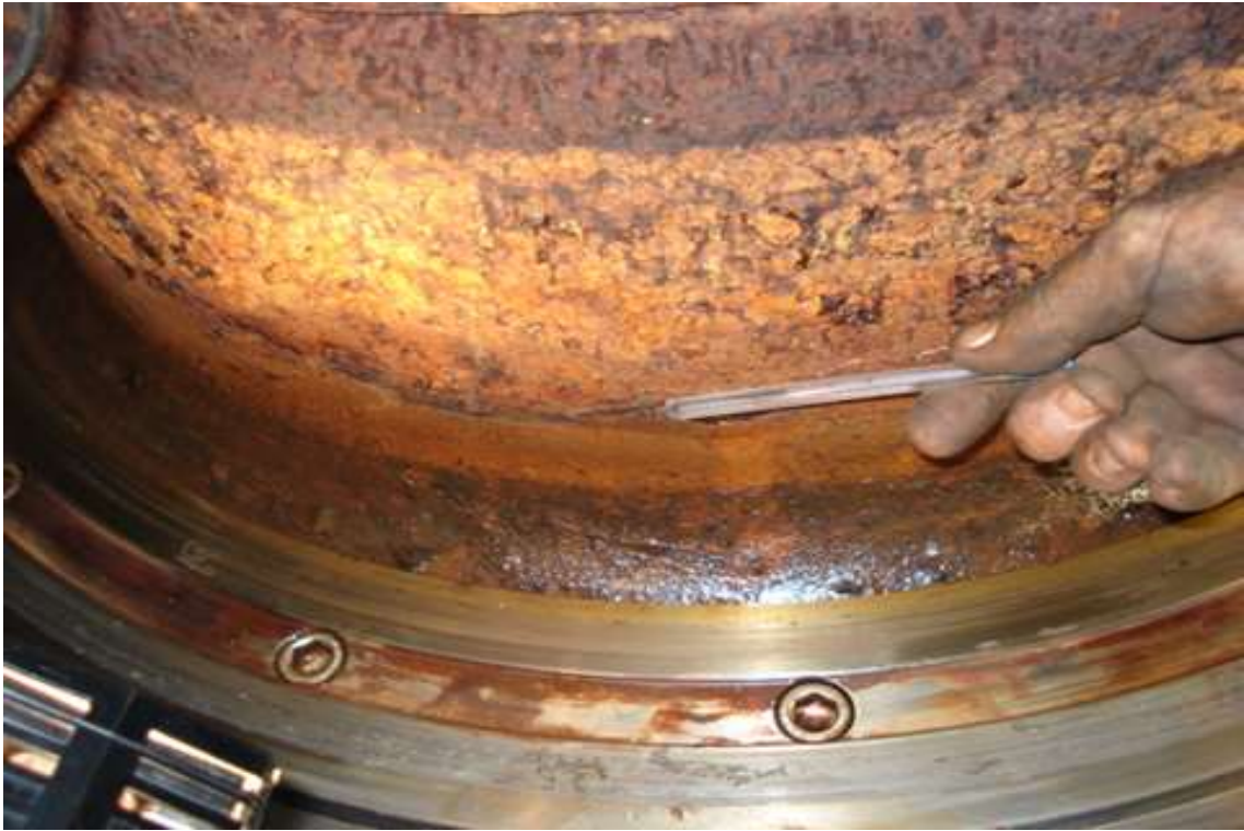
Figura 55: Corrosão perimetral do eixo dentro da caixa de vedação do eixo.
