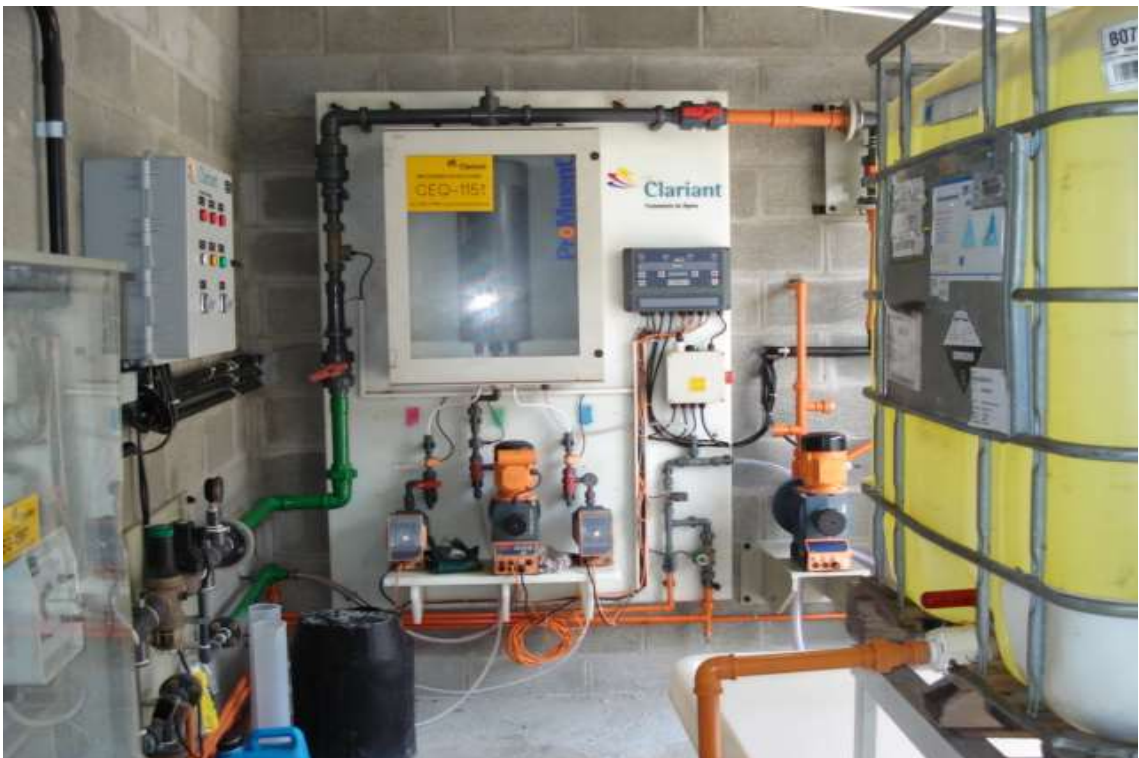
Figura 77: Sala de painel e bombas dosadoras para injeção de inibidores químicos.
