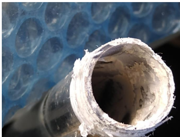
Fig. 9 - Incrustação inorgânica de cristais de carbonato de cálcio \text{CaCO}_3 devido ao uso de água dura em tubo sujeito a aquecimento acima de 85 graus. Fonte: Autor
