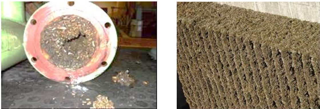
Fig. 8 - Oclusão da tubulação de água bruta do sistema de resfriamento por adultos de mexilhões dourado e grade de tomada de água incrustada por indivíduos adultos de mexilhão dourado na usina geradora de Salto Caxias. Fonte: [4]
