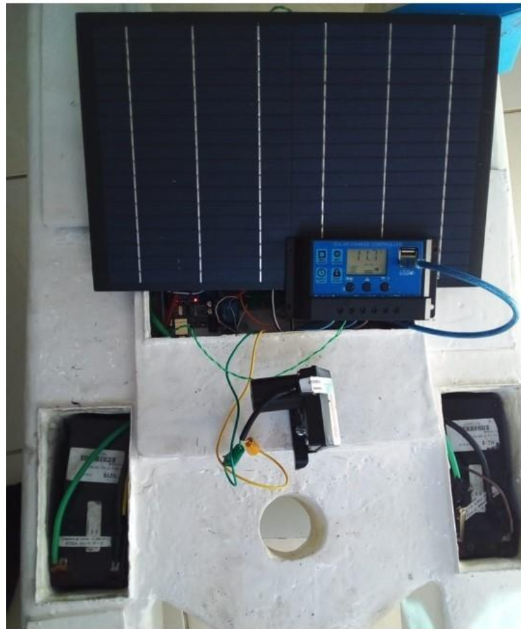
Figura 15: Controlador de carga. Fonte: Elaborada pelo autor, 2021.
