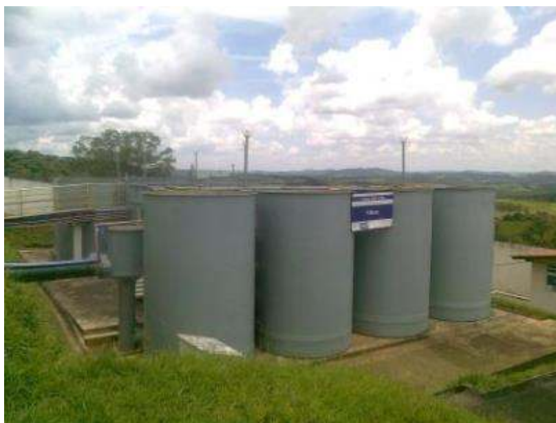
Figura 7: Estação de Tratamento de Água de Perdões.
