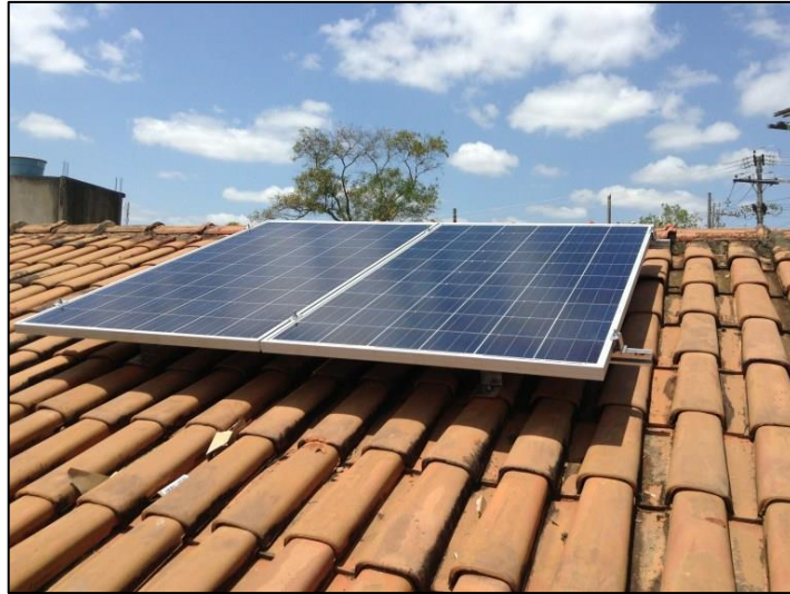
Figura 9 - Programa de Eficiência Energética (PEE) com a instalação de geração fotovoltaica em unidades consumidoras baixa renda (Fonte SANTA MARIA, 2016).
