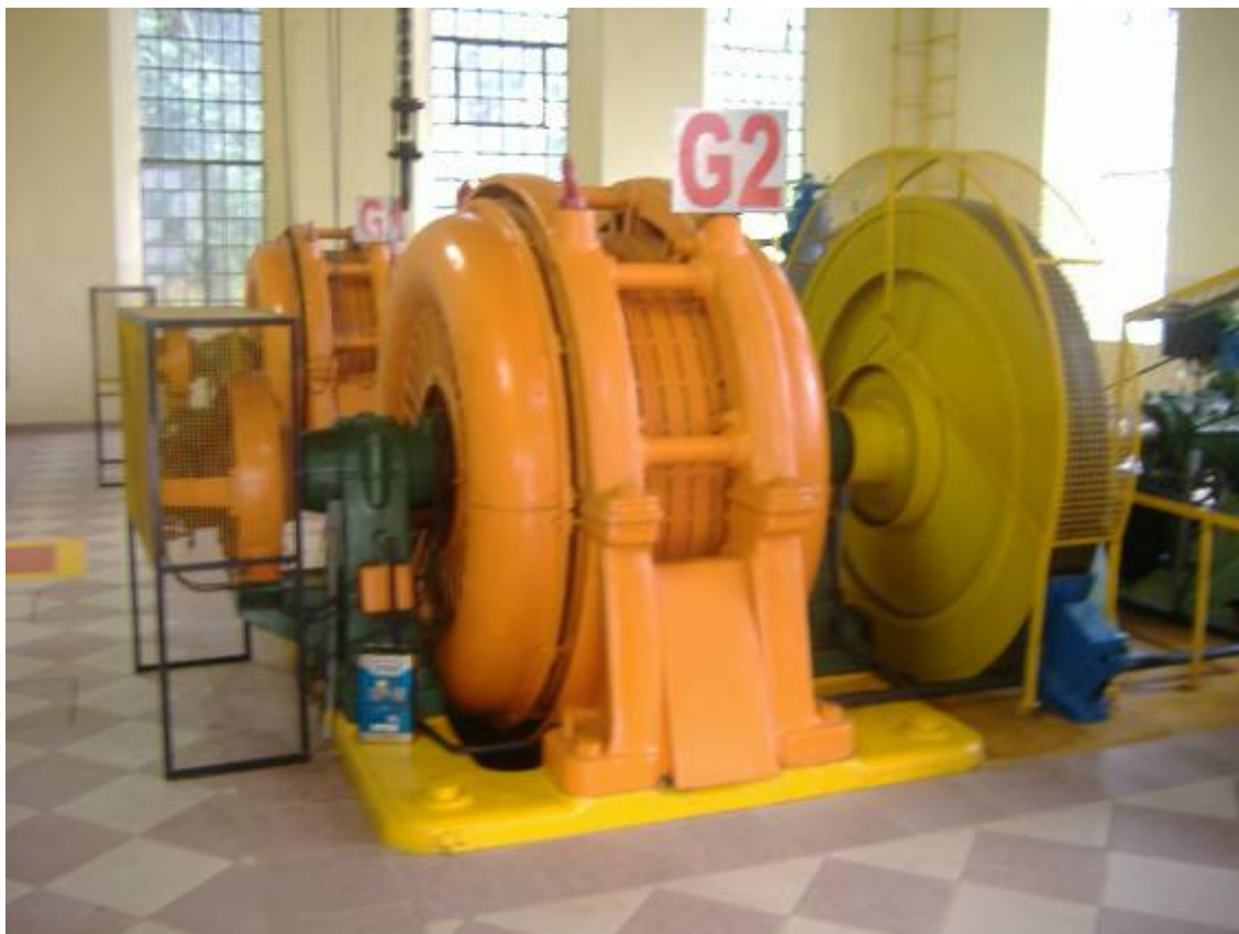
Figura 53 – Gerador 2 da PCH Luiz Dias
