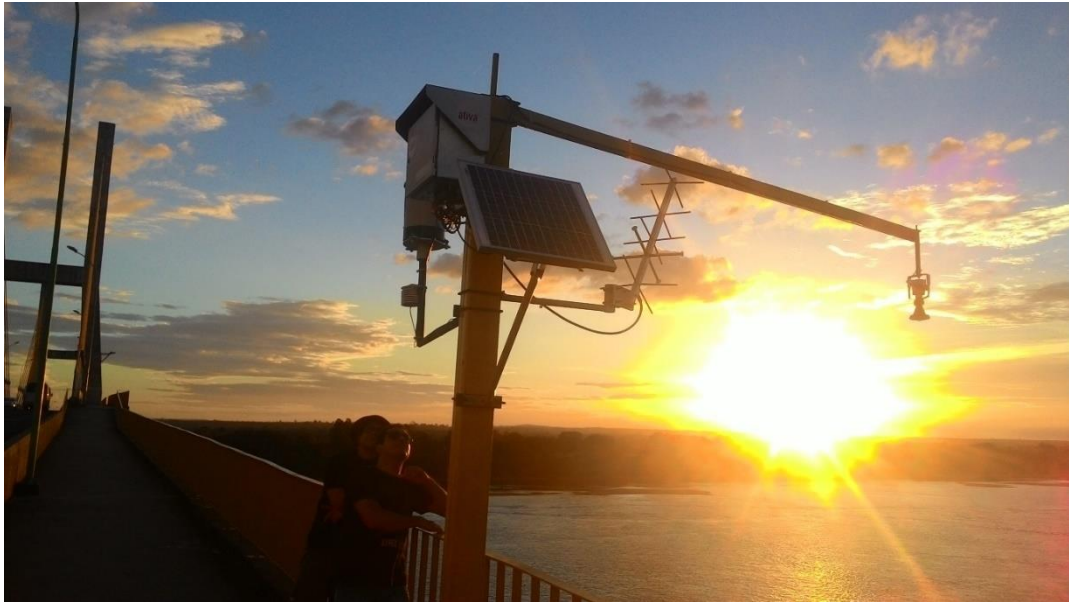
Figura 2-5 – PCD instalada às margens do Rio Tocantins. Fonte: O próprio autor
