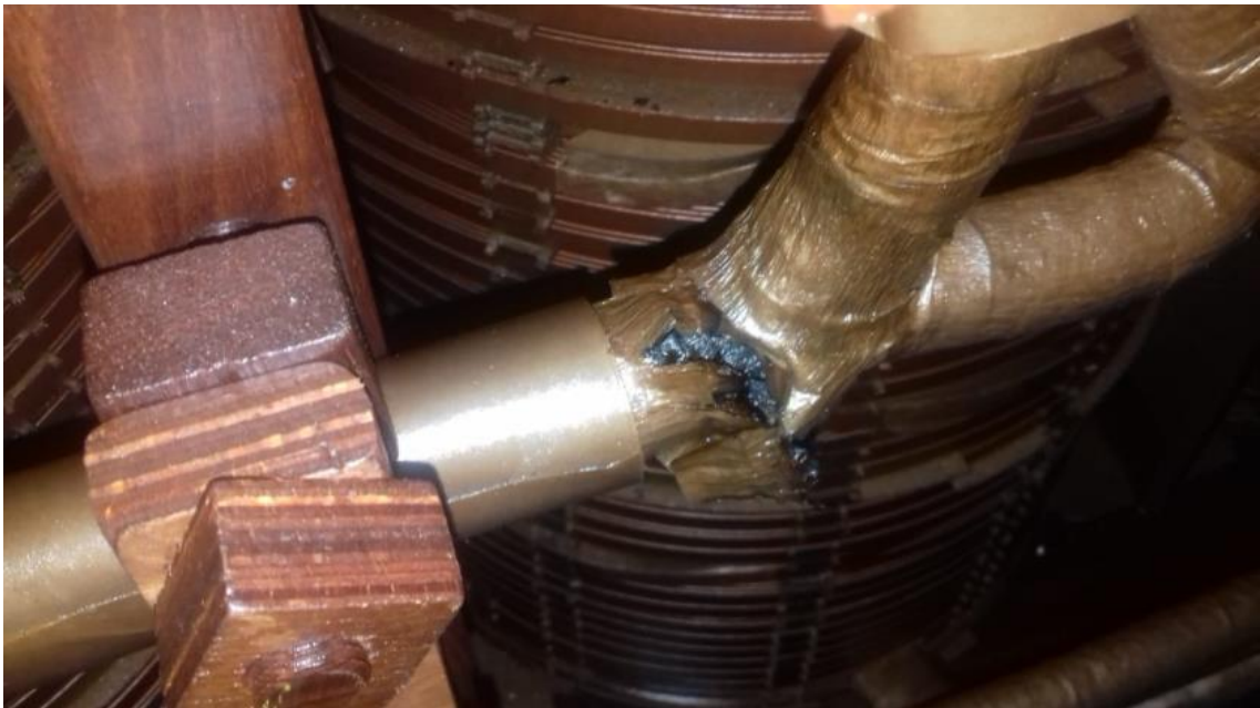
Figura 72 – Carbonização identificada no ponto de conexão da estrela
