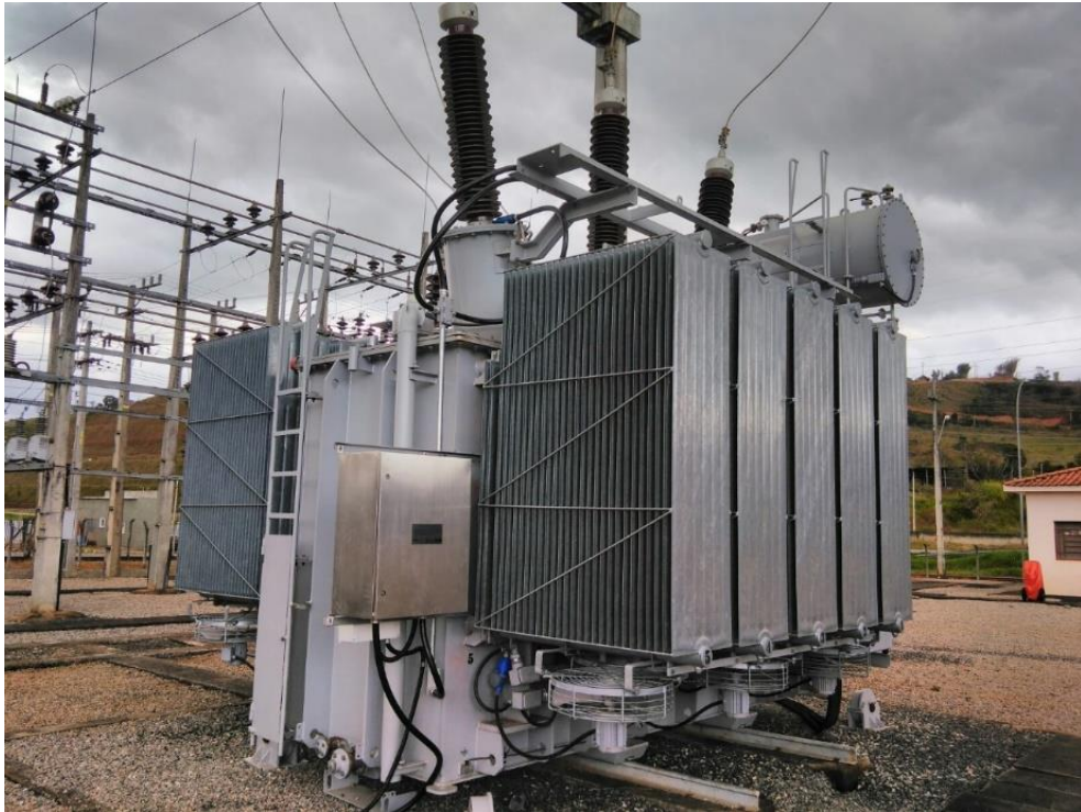
Figura 53 - Transformador 1 – Visualização da posição do painel
