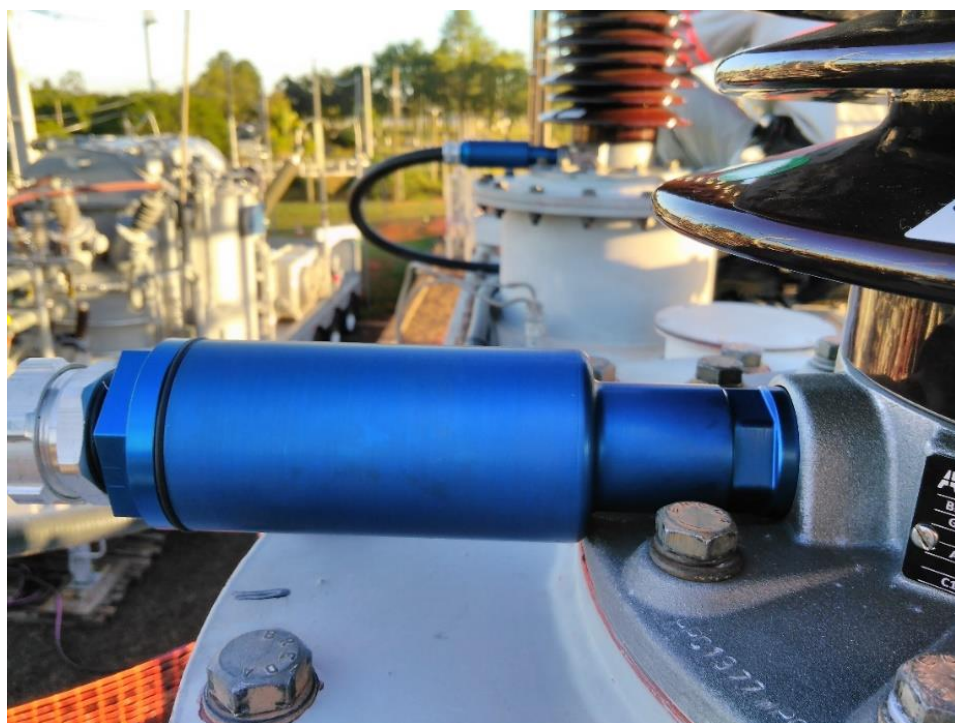
Figura 55 – Transformador 6 – Detalhe do acoplador
