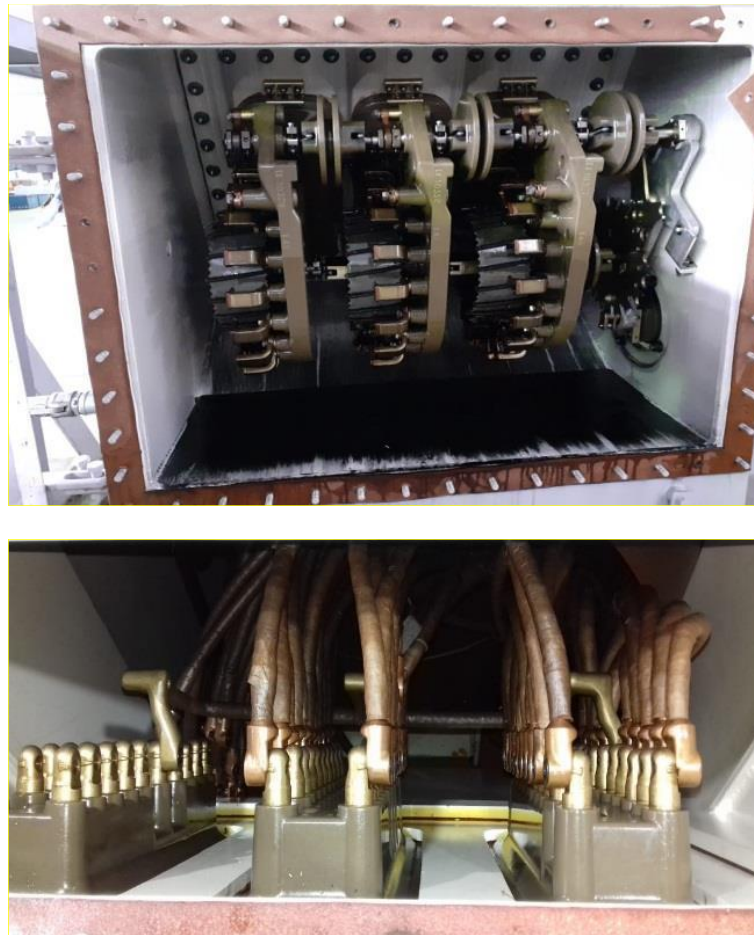
Figura 70 - Inspeção do comutador sob carga
