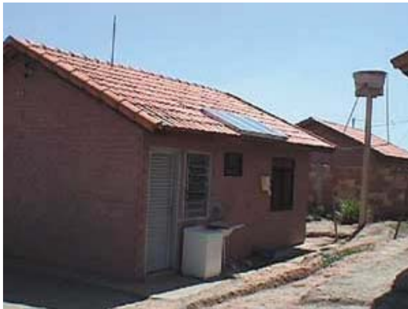
Figura 1.2: Coletor sobre o telhado (CEST, 2003).
