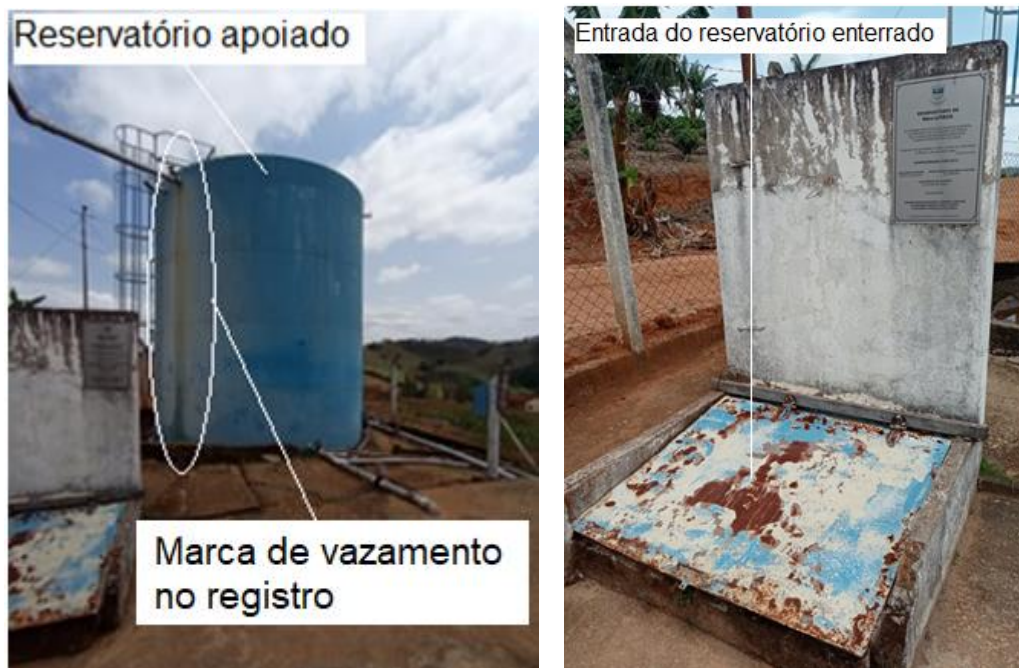
Figura 47 - Reservatórios localizados na ETA
