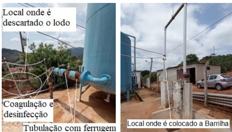
Figura 43 - ETA em condições precárias de manutenção
