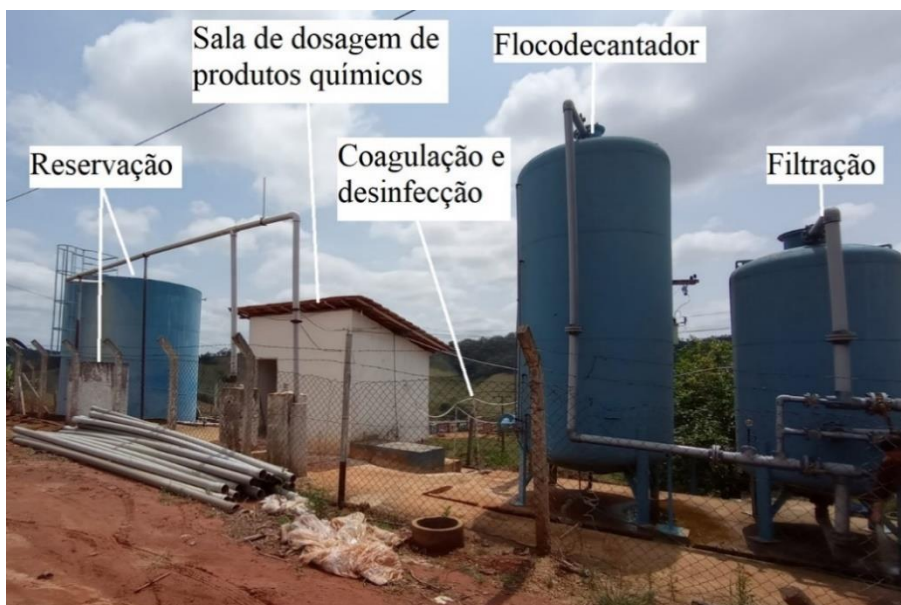
Figura 42 - Unidades da estação de tratamento de água de Conceição das Pedras
