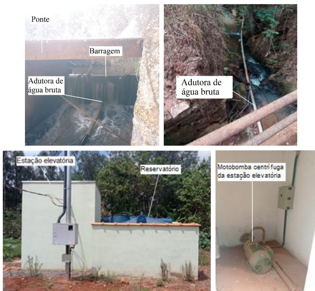
Figura 41 - Captação Superficial no Bairro Grota e estação elevatória
