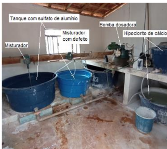
Figura 44 - Sala de dosagem de produtos químicos
