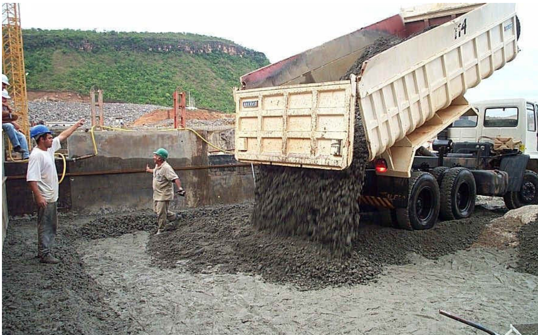
Figura 9 – Lançamento do CCR realizado por caminhão basculante. Fonte: Associação Brasileira de Cimento Portland
