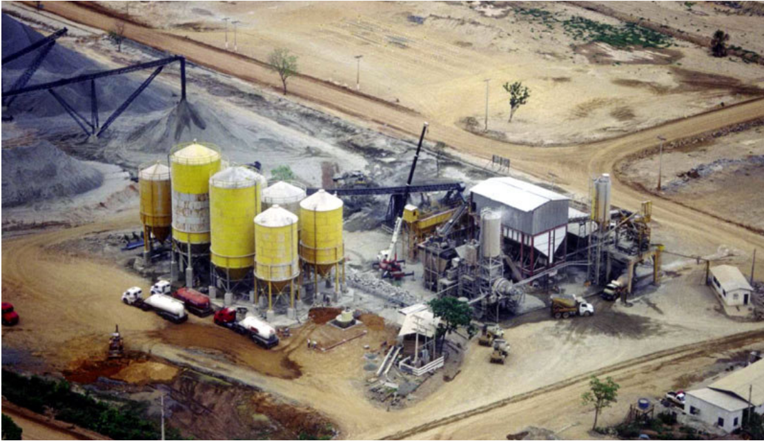
Figura 7 – Central de concreto da UHE Lajeado. Fonte: Consórcio Construtor Lajeado
