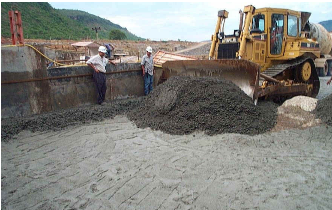
Figura 10 - Espalhamento do CCR realizado por trator de esteiras. Fonte: Associação Brasileira de Cimento Portland.
