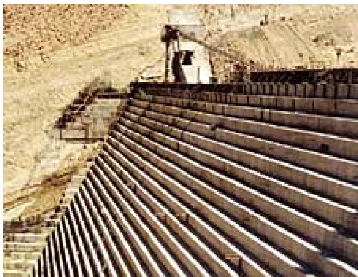
Figura 37 – Detalhe do paramento de jusante executado em degraus. Fonte: International Water Power & Dam Construction
