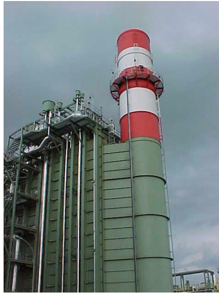
Figura 3.40 - Sistema de exaustão da caldeira de recuperação.
