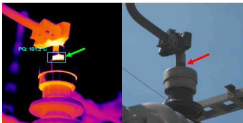
Figura 2.27 – Registro de anomalia térmica detectada em inspeção termográfica [32].
