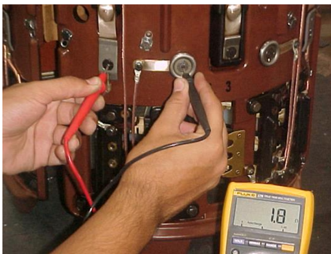
Figura 2.24 – Medição de uma das resistências de transição de CDC [30].
