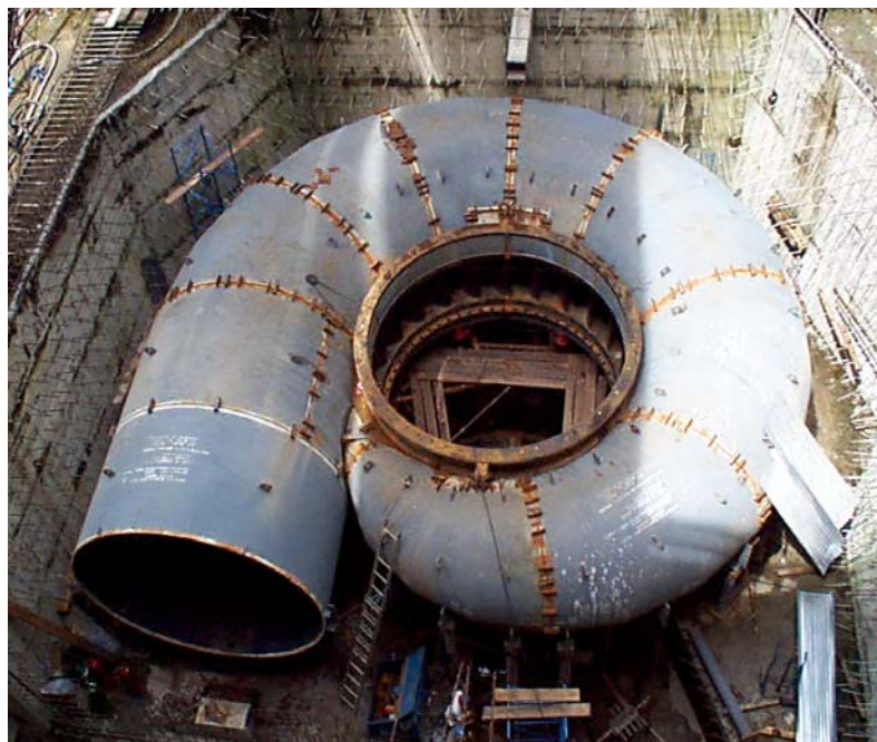
Figura 3.1 Caixa espiral com pré-distribuidor de uma turbina Francis de eixo vertical
