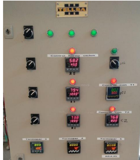
Figura 30 - Painel de segurança e controles de temperatura
