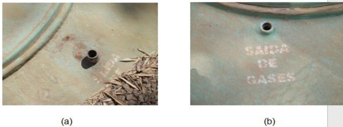
Figura 14 – Saída de gases do sistema. (a) Saída do reator UASB; (b) Saída do filtro biológico.
