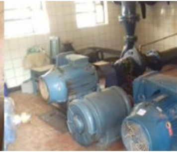
Figura 20b: Conjunto de motobombas em operação
