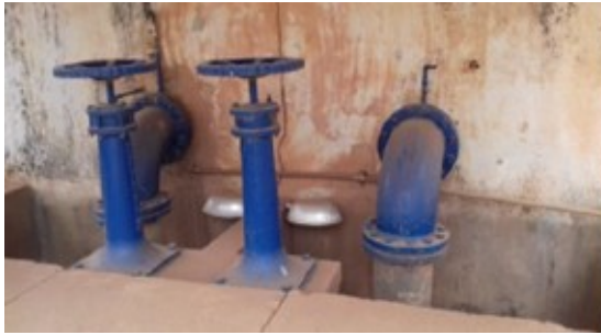
Figura 20a: EEAB para captação de água bruta.
