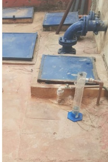
Figura 25: Tanque de contato
