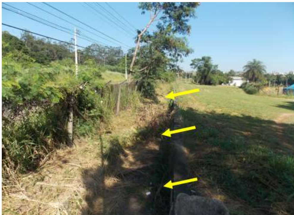
Figura 21 - Calha de Escoamento da Água Pluvial da Empresa X
