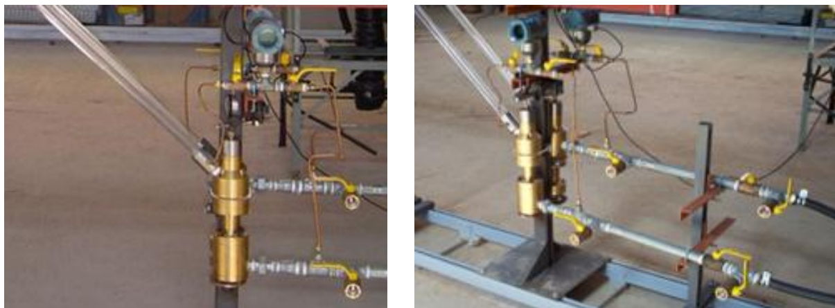
Figura 3-10 – Vista das válvulas de ciclônicas instaladas e seu trecho de saída.
