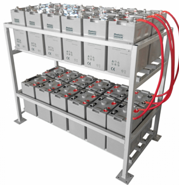
Figura 4: Banco de baterias Fonte: UNIVERSE (2005)
