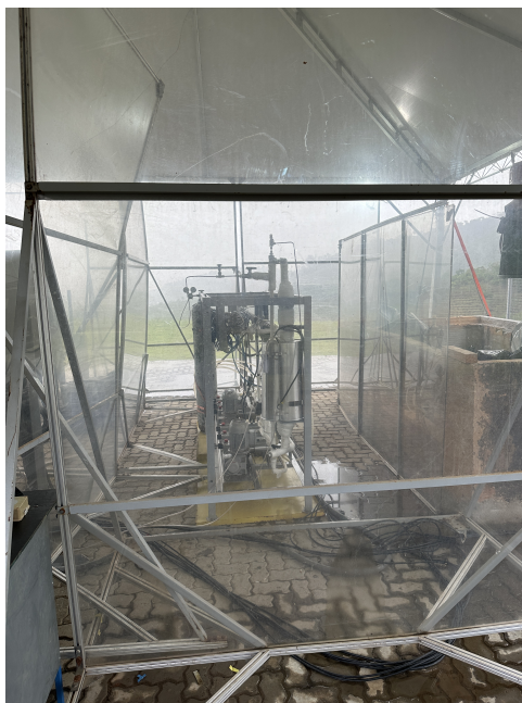
Figura 67 – HP loop instalado na área de teste do CTPB.
