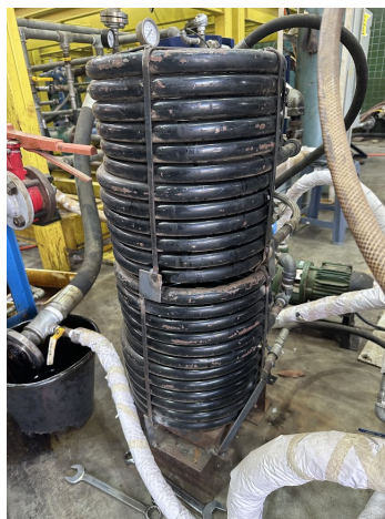
Figura 31 – Trocador de calor de tubo em tubo da UNIFEI-NUSEC.
