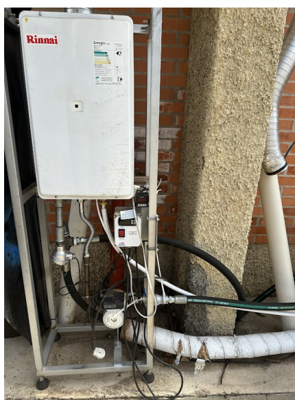
Figura 38 – Aquecedor a gás de água quente.
