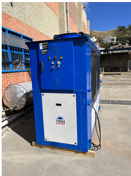
Figura 45 – chiller utilizado para refrigerar o reservatório de água fria.
