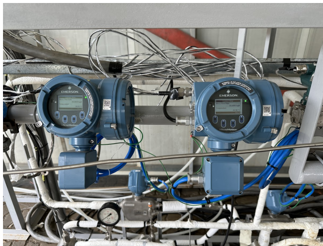
Figura 71 – Medidores de vazão e temperatura Coriolis do HP loop .
