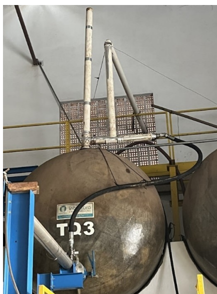
Figura 47 – Separador de gás-líquido do tanque TQ-3.
