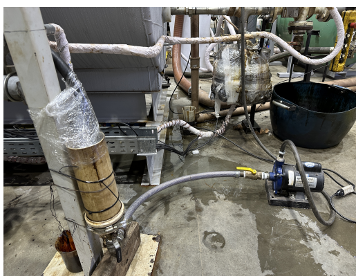
Figura 61 – Bomba de agitação de solvente no trecho com deposição.
