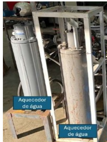
Figura 39 – Aquecedores elétricos da seção de fornecimento de água quente.
