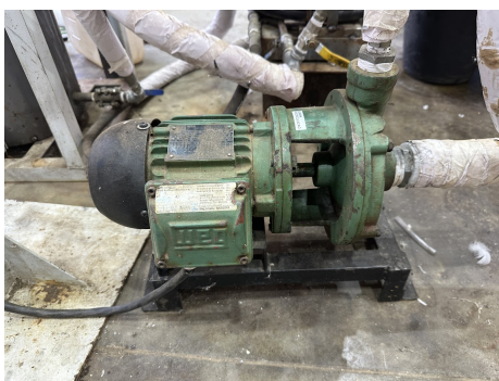
Figura 37 – Bomba centrífuga de água quente.
