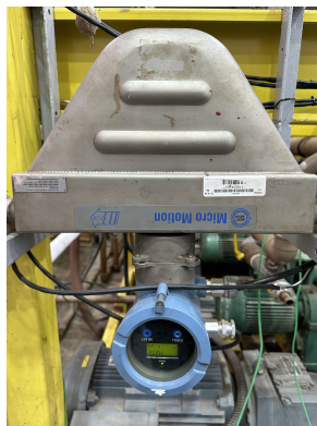
Figura 56 – Medidor de vazão e temperatura Coriolis para a corrente de ar.
