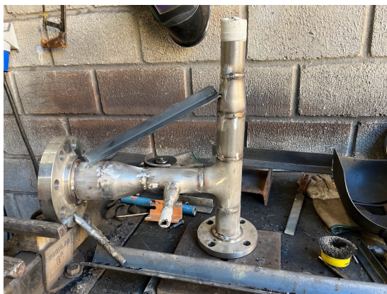
Figura 34 – Spool de entrada e de saída para conexão do tubo de deposição com os medidores de pressão diferencial e de temperatura.
