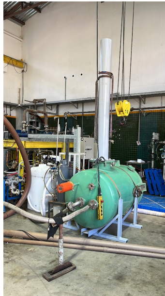
Figura 48 – Separador de gás-líquido do tanque menor.
