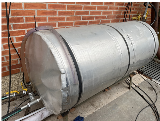
Figura 36 – Boiler de água quente.
