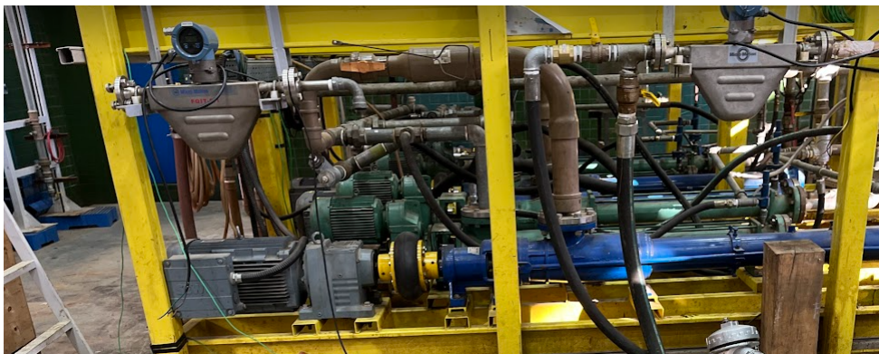
Figura 30 – Sistema de bombeio de petróleo da UNIFEI-NUSEC.
