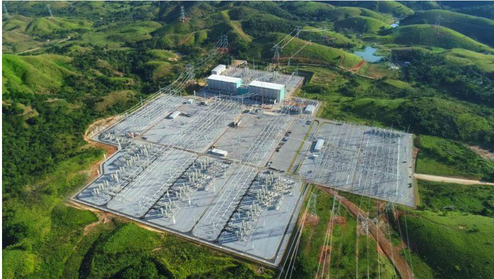
Figura 4.6: Subestação Terminal Rio da State Grid (Haddad, 2025)
