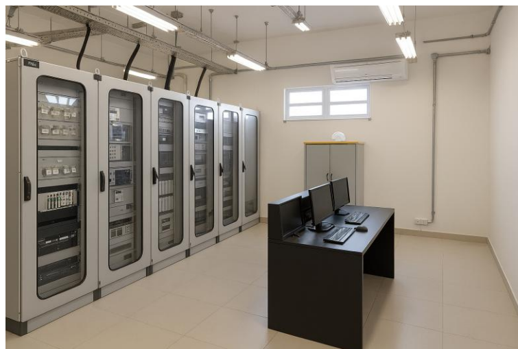
Figura 4.13: Painéis na casa de comando da SE Jauru (Planova, 2025)
