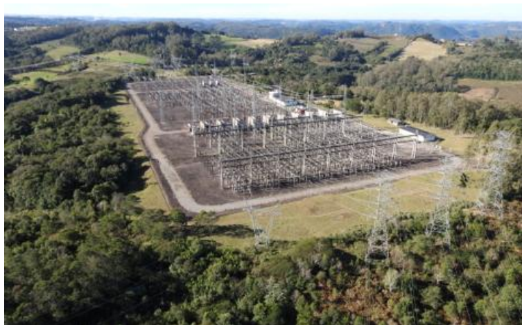
Figura 3.1: Instalações de transmissão - SE Caxias (Doc.news, 2022).
