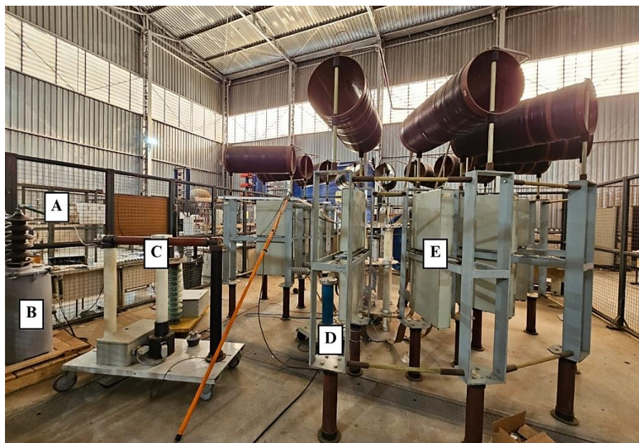
Figura 38. Cella de ensaio de impulso de corrente. Resistor limitador de corrente (A), fonte de tensão AC (B), diodo retificador (C), divisor capacitivo (D) e banco de capacitores (E).
