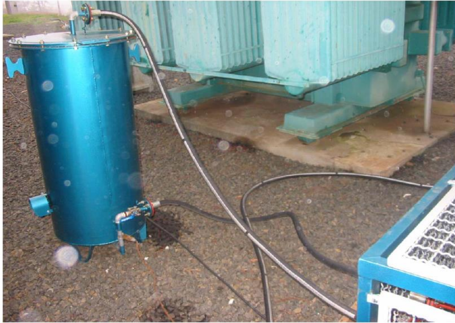
Figura 6: Detalhe o filtro percolador contendo terra Fuller
