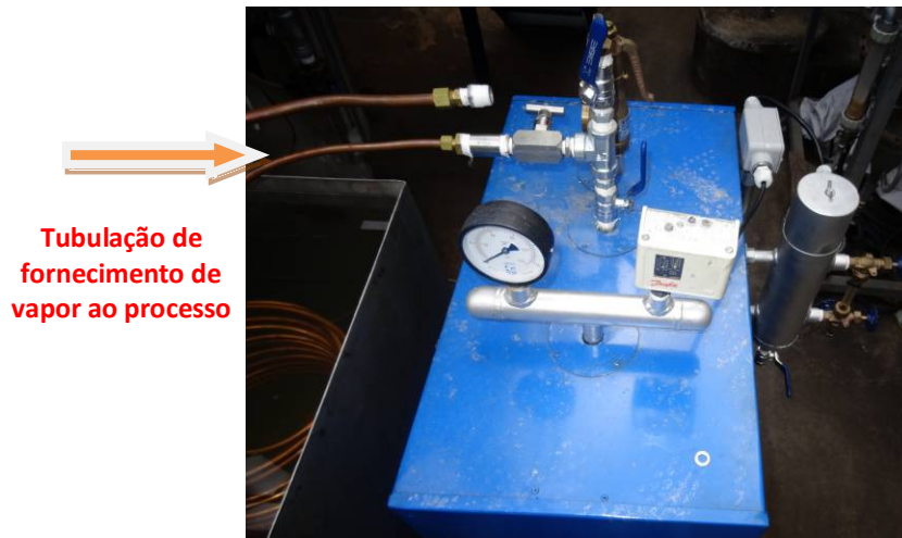
Figura 36. Tubulação de fornecimento de vapor ao gaseificador
