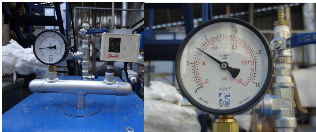
Figura 35. Manômetro e pressostato para controle da pressão da caldeira
