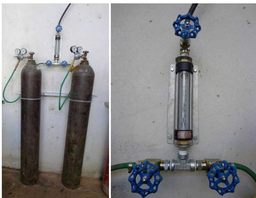
Figura 39. Cilindros de O 2 e rotâmetro para controle de fluxo de oxigênio do processo
