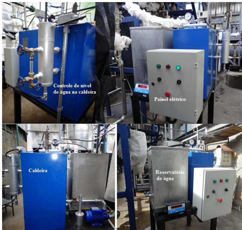
Figura 34. Módulo de Geração de Vapor – Caldeira elétrica, reservatório de água, balança digital, bomba hidráulica.
