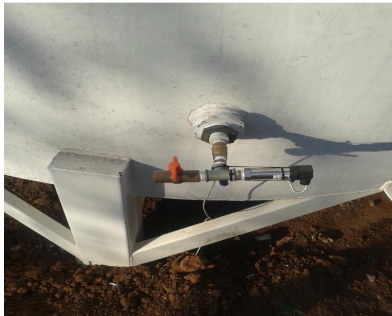
Figura 26 - Medição do nível dos reservatórios.
