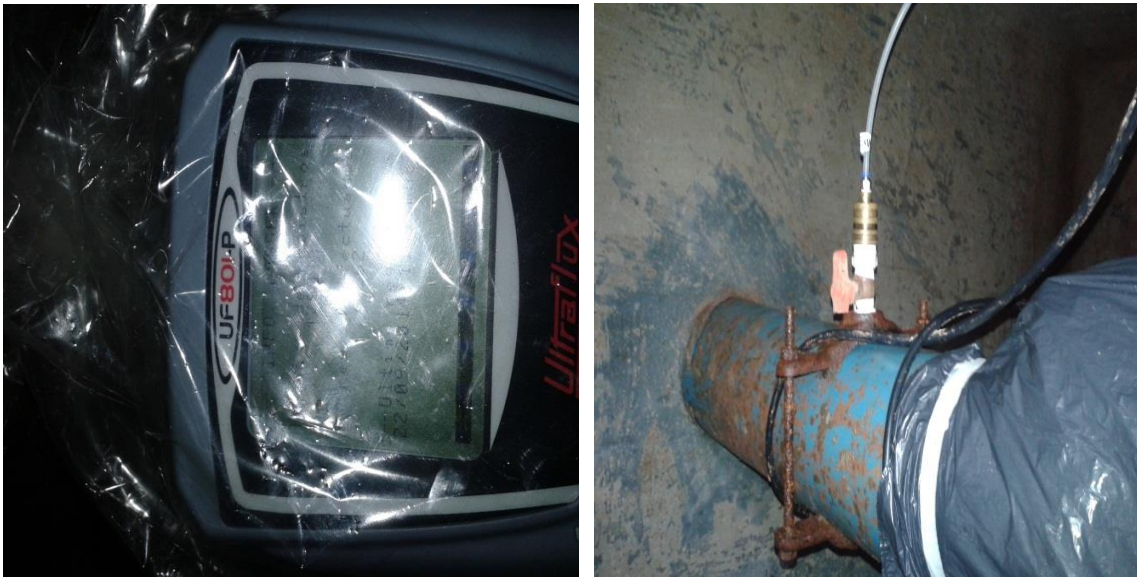
Figura 42 - Medidor de vazão ultrassônico no poço de visita.
