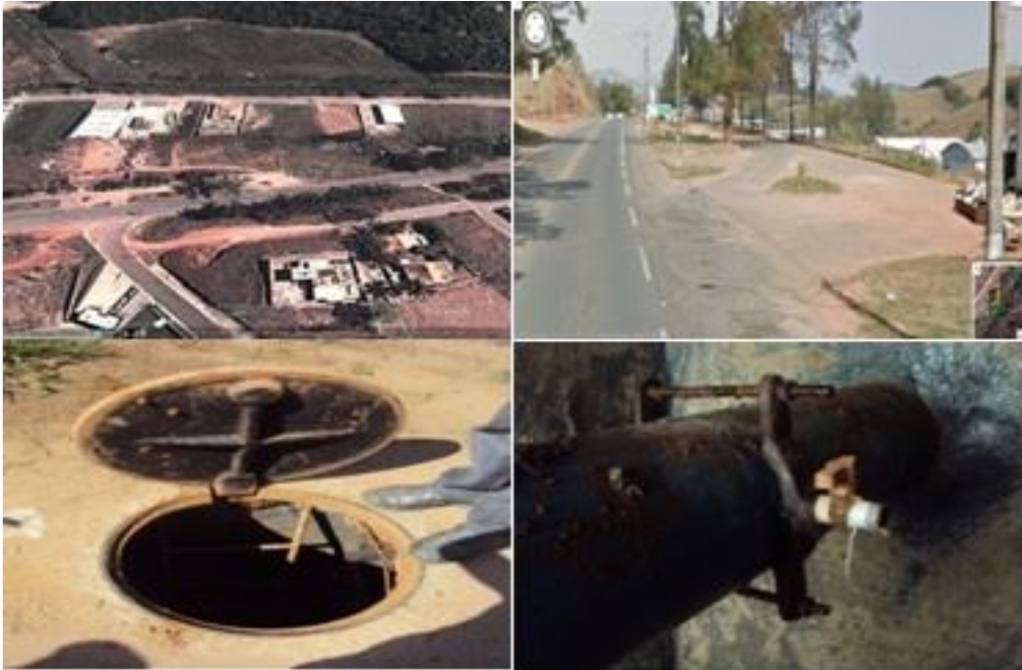
Figura 39 – Posto de visita para instalação dos equipamentos de vazão e pressão.
