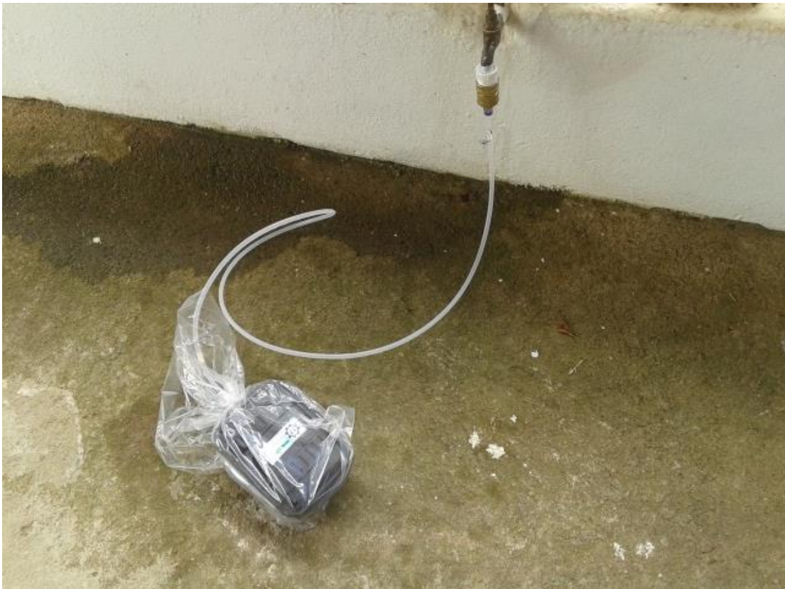
Figura 24 - Medidor de pressão instalado em uma das residências cadastradas.
