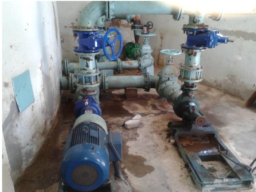
Figura 40 - Sistema de bombeamento Vila Nova.
