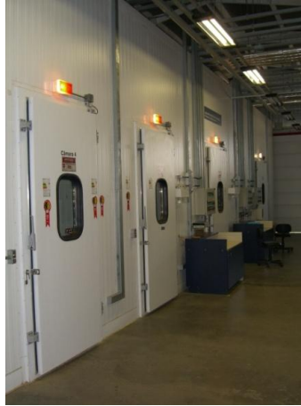
Figura 5.2 – Laboratório de ensaio em refrigeradores (Labelo)
