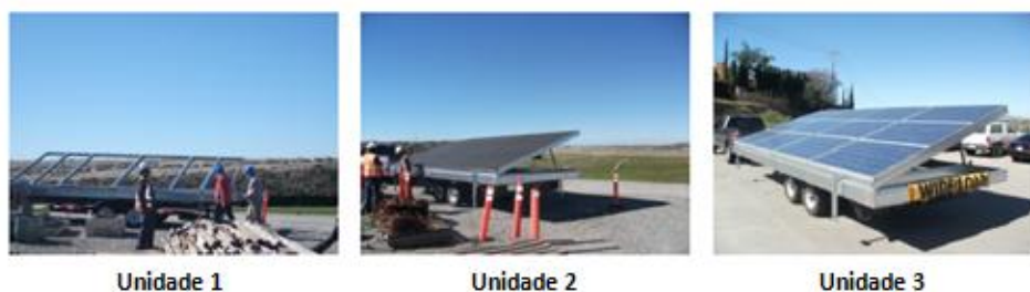
Figura 26. Unidades instaladas no estudo. Fonte: Traduzido de PV Navigator, 2013.
