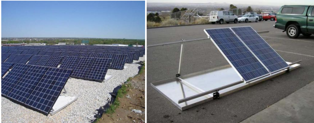
Figura 22. Instalações solares nas superfícies planas.
