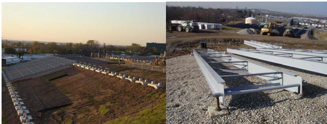
Figura 23. Instalações solares nos taludes. Percebe-se a utilização de estruturas de aço para colocação dos módulos fotovoltaicos.
