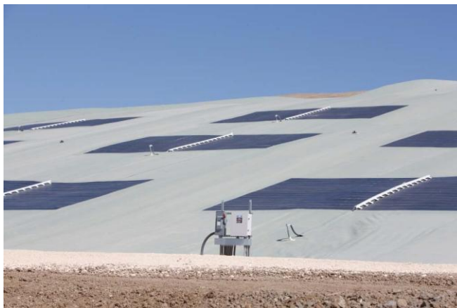
Figura 15. Lâminas fotovoltaicas flexíveis instaladas sobre geomembrana no aterro Tessman Road em San Antonio, Texas - Estados Unidos. Fonte: Sampson, 2009.
